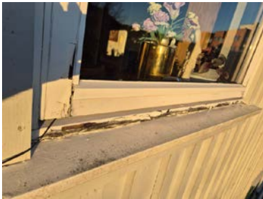
Utvendig værslitt vindu.
