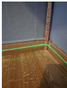
Skjevheter på gulv i soverom 2.
