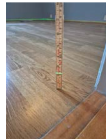
Skjevheter på gulv i soverom 2.
