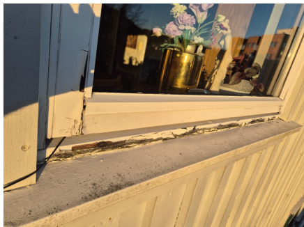
Utvendig værslitt vindu.
