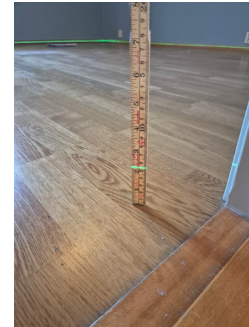
Skjevheter på gulv i soverom 2.
