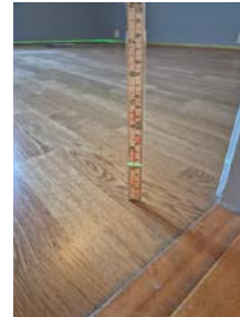
Skjevheter på gulv i soverom 2.
