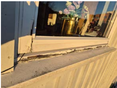
Utvendig værslitt vindu.
