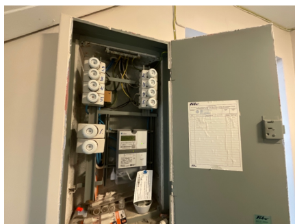
Sikringsskap i felles trappegang.
