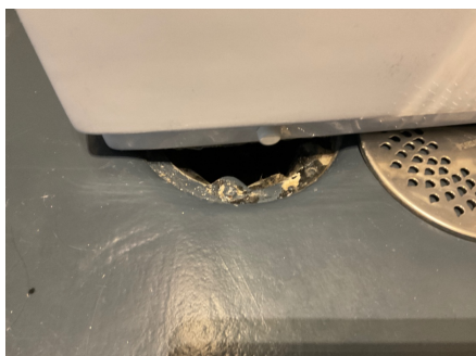
Sluk under dusjkabinett
