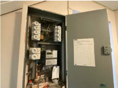
Sikringsskap i felles trappegang.
