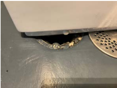
Sluk under dusjkabinett
