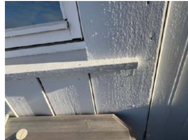
Sideomramning/kledning ned på vannbrett uten beslag.
