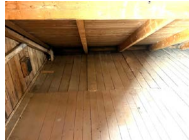
Tett i raftet (overgang vegg/tak). Tegn til lite lufting i raft.
