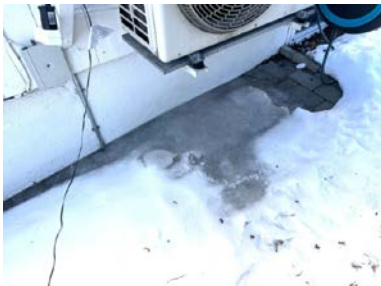
Grunnmur på sørsiden: Ingen synlig utvendig tettesjikt.
