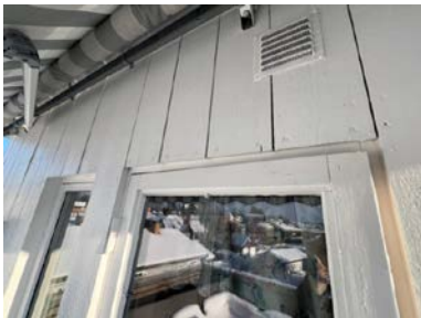
Ingen vannbrett/beslag over vinduer.
