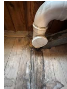
Liten skade pga kondensering i fm lufting/rør.
