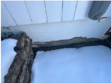
Grunnmur på nordsiden: Ingen synlig utvendig tettesjikt.
