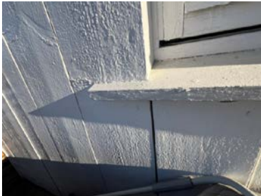
Sideomramning/kledning ned på vannbrett uten beslag.
