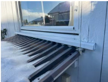
Råtekadet kledning ved vindu.
