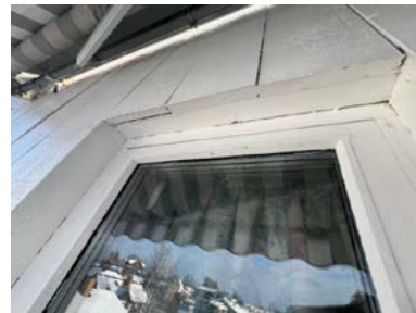
Ingen vannbrett/beslag over vinduer.
