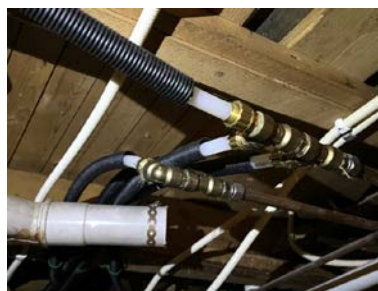
Åpent rør rør system i kjeller.
