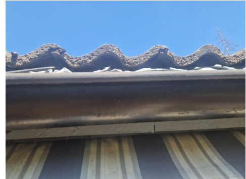
Avskaling beslag og mindre rust synlig.
