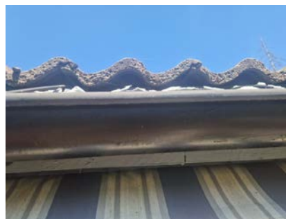
Avskaling beslag og mindre rust synlig.
