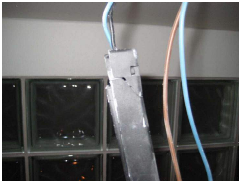
Avvik 28: Defekt trafo.
