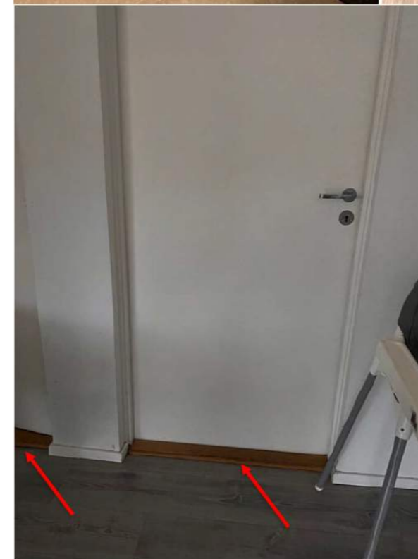
Piler på bilder over viser Z-terskler (holder dør og karm tett) og ingen luftespalte under dører. Dør til badet (døren til høyre er vanskelig å lukke da den er skjev).
