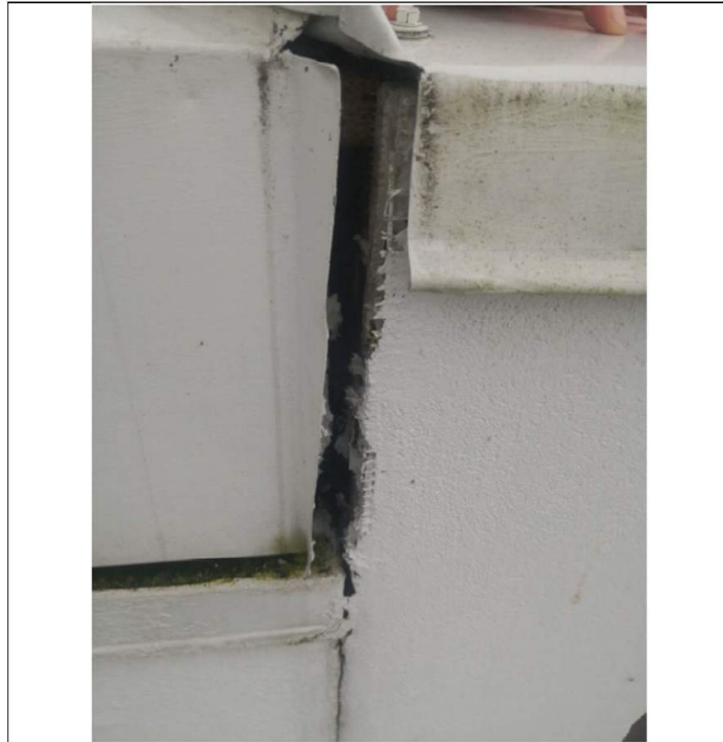
13. Bildet viser utett løsning ved hjørne nordvest.
