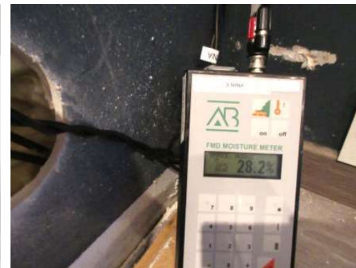
Foto 9. Hulltaking utført i nedkant av ytterhjørnet. Høy trefuktighet i overkant av bunnsvill (>28 vekt % = vått).
