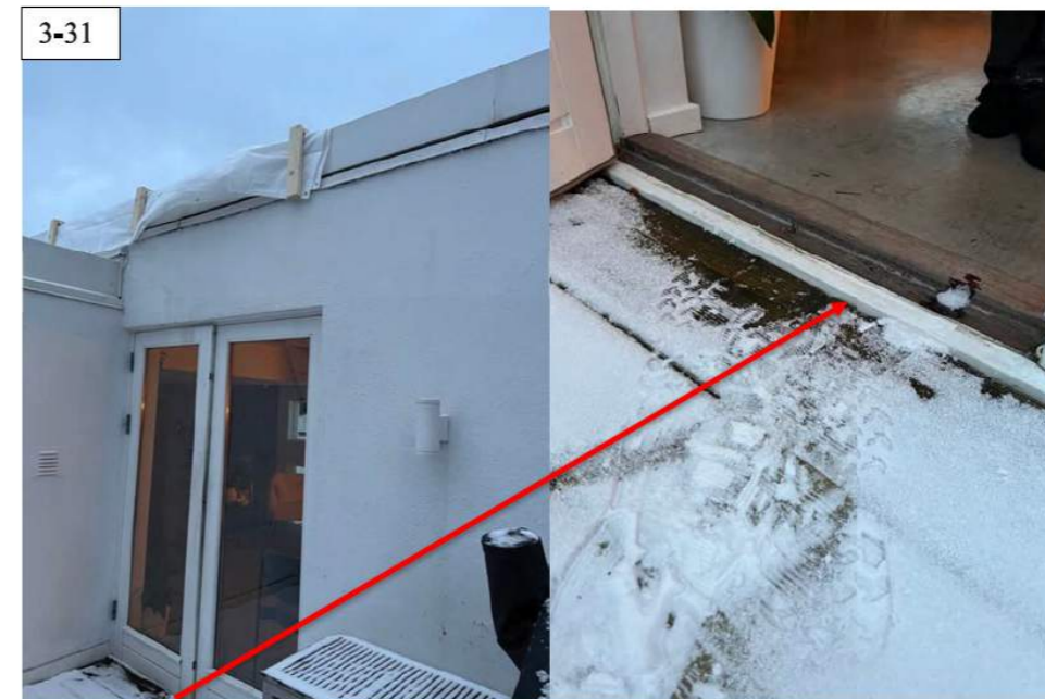
Pil på bildet viser terskelen til balkongdøren til kjøkkenet. Bildet til venstre viser at det ikke er tak over døren og fører dermed til at regn- og smeltevann renner inn i boligen. Å kun etablere rist utenfor døren vil ikke løse problemet da slike rist fylles med is på vinteren samt løv og annet på vår/høst som vil føre til at risten mister sin funksjon. Det er en bransjebefaling med tak over inngang- og balkongdører for å forhindre regn og snø fra å renne mot åpne konstruksjoner som dører.
