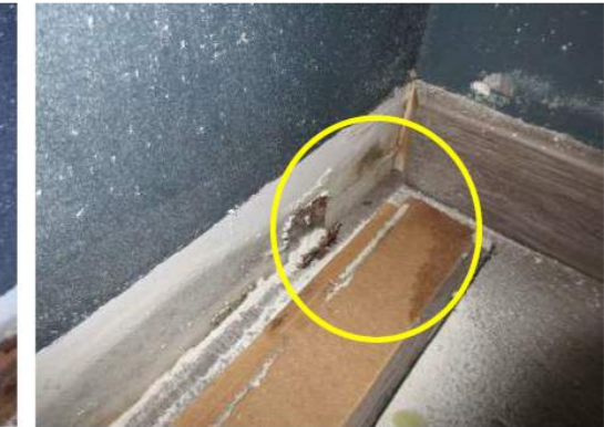
Foto 11. Ytterhjørne. Muggsoppvekst på gipsplate bak gulvlist (ring). Dette er under hull i øvre del av vegg (tidligere eier). Fukt-/ muggsopp registrert bak løsnet gulvlist.
