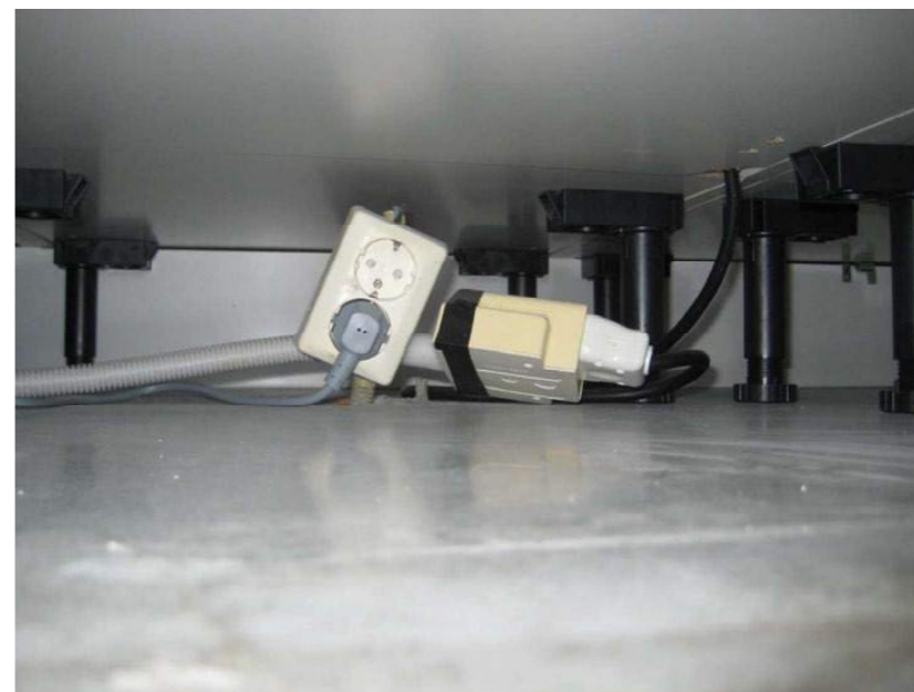
Avvik 49 og 50: Ikke fagmessig utførelse.
