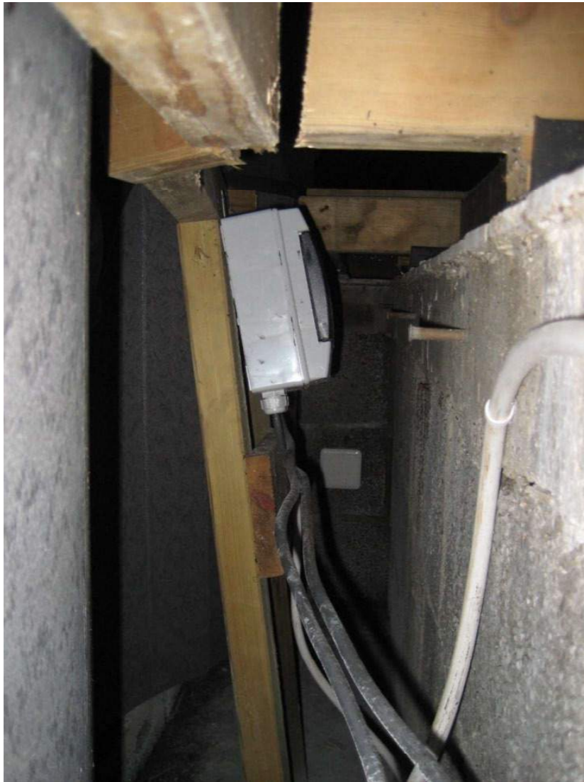
Avvik 55: Ikke fagmessig utført. Legges om i sin helhet. Installasjon tilhører ikke boblebad.
