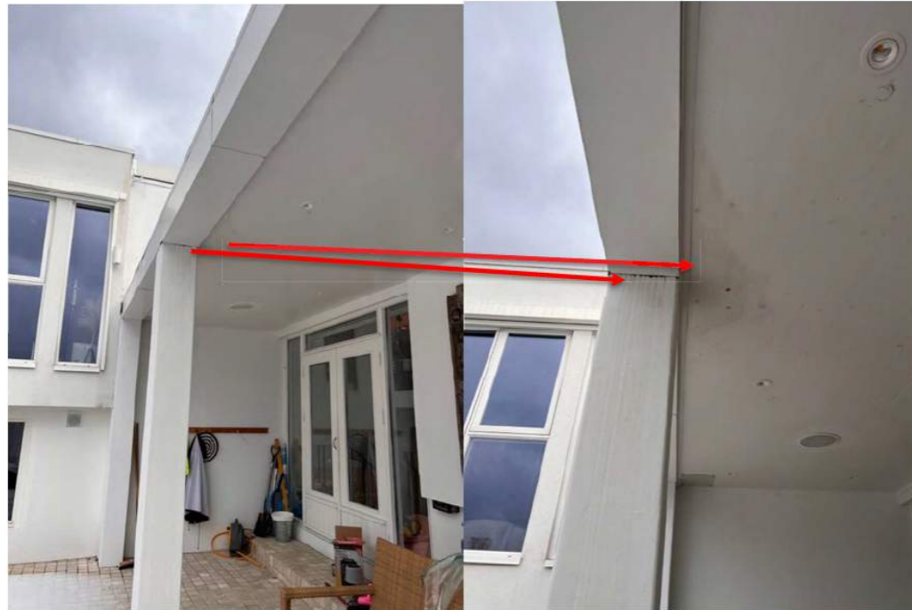
Det er avdekket tegn til lekkasje fra yttertak ved misfarging av plater i taket til takoverbygget over deler av utearealet.
