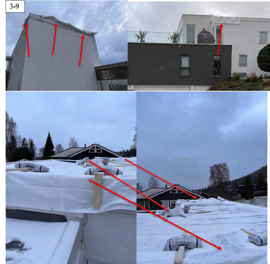
Det er avdekket flere byggefeil og lekkasjepunkter fra nesten samtlige tak på boligen.
