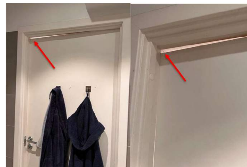
Dør til vaskerom er feilmontert og ikke mulig å lukke.
