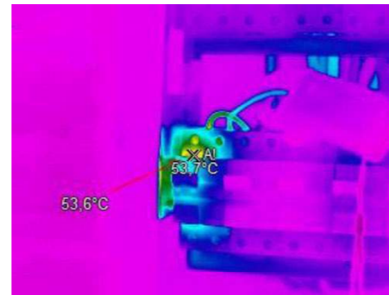
Avvik 18: Termogram kurs 26
