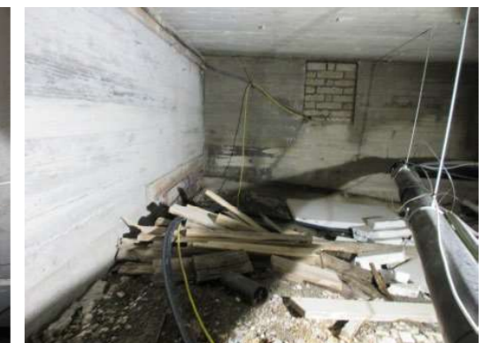
Foto 49. Krypekjeller. Noen rom har mye lagrede bygningsmaterialer. Risiko for muggsopp- og råteskader i dette.
