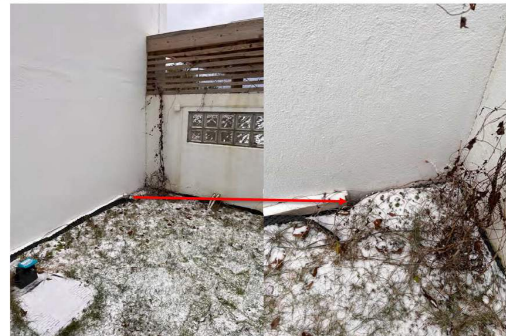
Pil på bilder over viser hvordan isolasjonen på veggen er avsluttet for kort og det er åpning over drencappen der isolasjonen avslutter.
