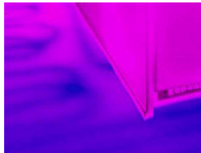
Avvik 35: varmekabel er ikke installert i henhold til fabrikantens anvisning, ikke fagmessig utført. Kabel ligger innunder vegg. I tillegg krysser den sin egen bane, ref minimum C-C på 5 cm.
