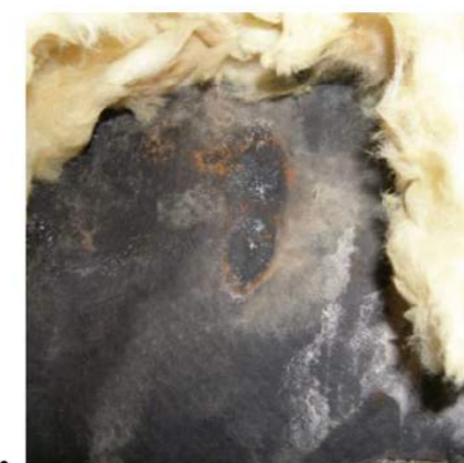
Aktinobakterier på forhudningspapp i en utlektet kjellervegg
