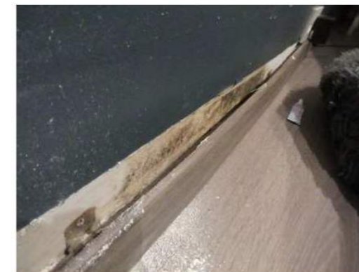
Foto 12. Langvegg under terrengnivå. Muggsoppvekst på gipsplate bak løsnet gulvlist.
