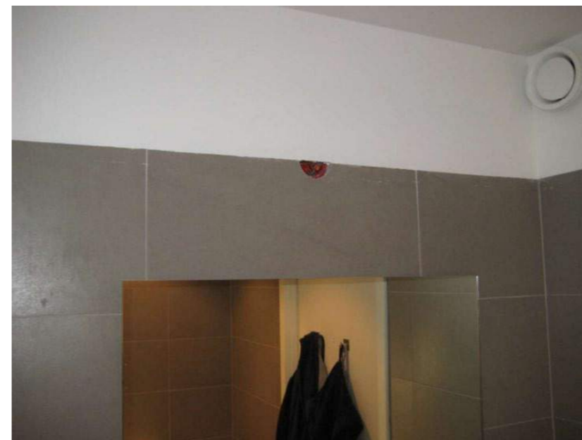
Avvik 3: Veggboks ikke tilgjengelig.
