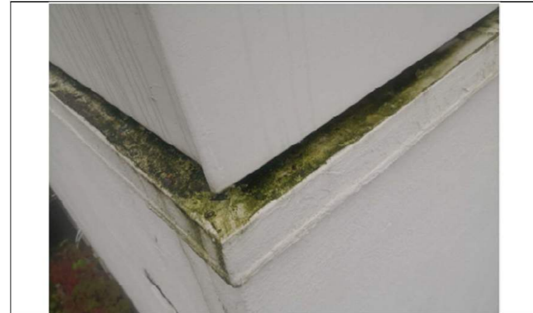
14. Bildet viser hjørne over treningsrom mot vest. Her mangler fall på beslag.
