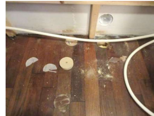
Foto 21. Hullboring i nedkant av yttervegg og i tregulv ble utført for kontroll.
