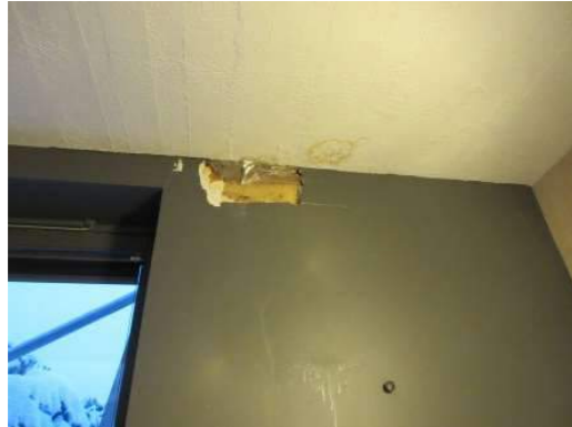
Foto 19. Yttervegg hvor det ble oppdaget lekkasje i september 2022. Hulltaking var utført på forhånd. Fuktskjold på støpt dekke og rennemerker på vegg registrert.
