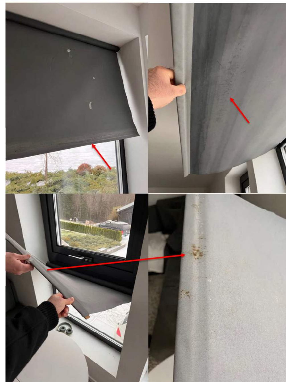
Piler på bilder over viser sopp på rullgardiner i stuen til utleiedelen.
