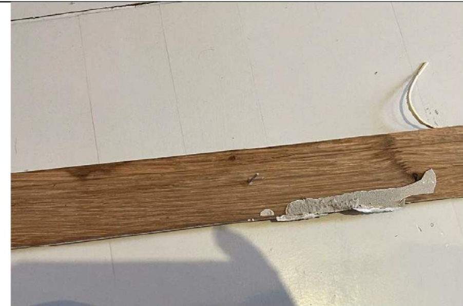
7. Bildet viser fuktmerker på fotlisten.
