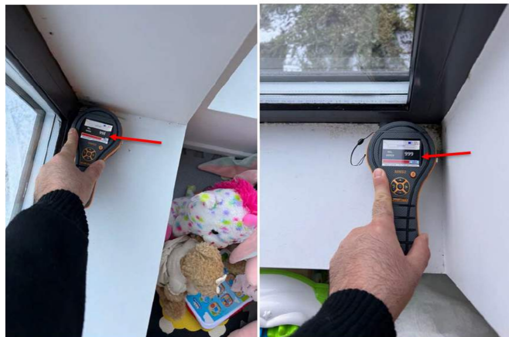
Piler på bilder over viser at det er fullt utslag på fukt i vinduskarmer.
