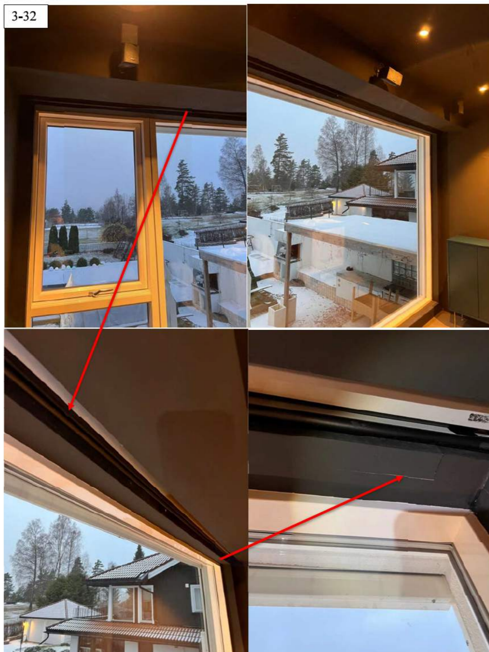
Piler på bilder over viser lerretet på soverommet i 2. etasje, som er fuktskadet som følge av vannlekkasje fra tak. Motor til lerretet er defekt. Pil på bildet til høyre viser at sparklekanter sprekker opp som følge av vannlekkasjen.
