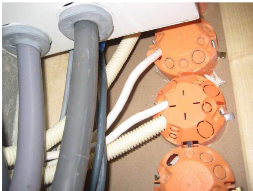
Avvik 22: Ikke fagmessig utført.
