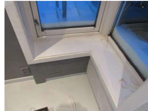
Foto 40. Kondens på eldre vindu. Skjolder på overflatene. Opplyst av eier at vinduet har råteskader registrert fra utvendig side.
