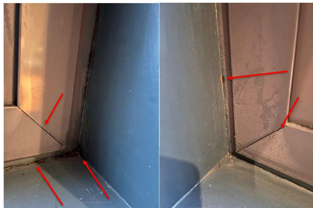
Piler på bilder over viser kondensering, fukt i vinduskarmskjøter og sopp rundt vinduskarmer. Disse vinduene er på soverommene i utleieleiligheten.
