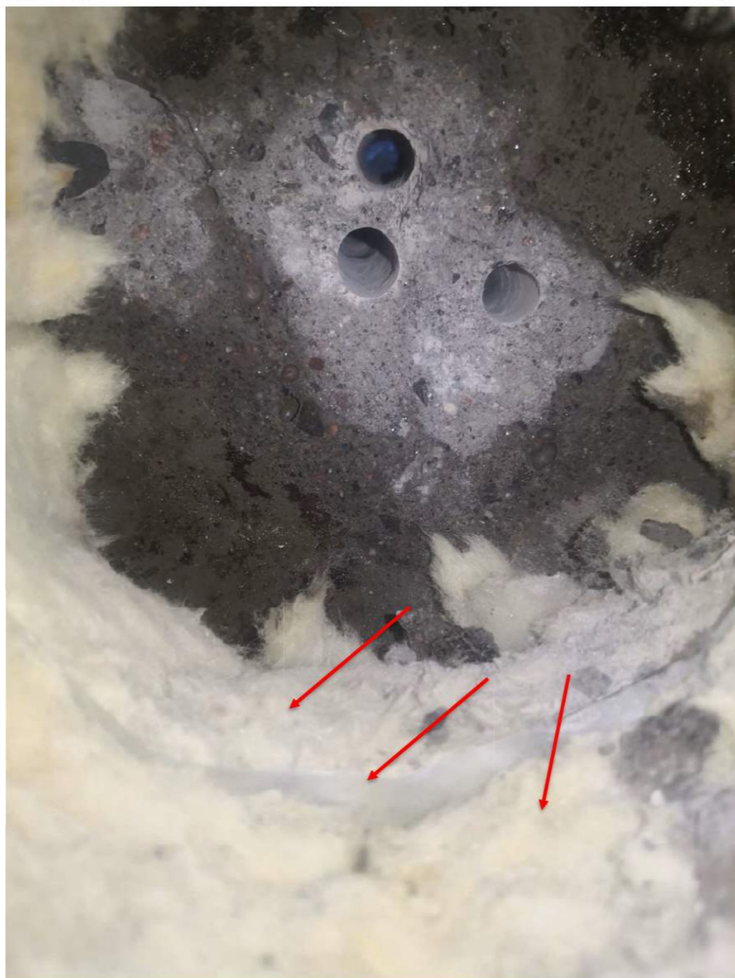
Bildet viser hullet som er nevnt og merket på bildene over. Fukten fra kondens er veldig tydelig på dette bildet. Røde piler på bildet viser at vegg er isolert med 5cm bak plast mot betongvegg og 5cm på innsiden av plasten. Dette er helt feil oppbygging og isolering av en betongvegg.
