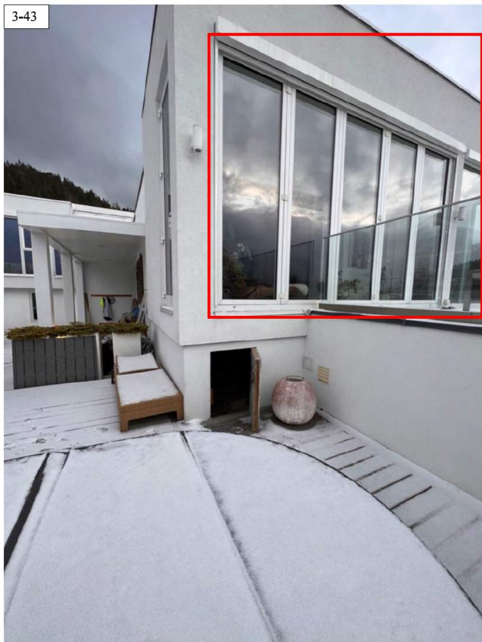
Merket område på bildet viser foldedører til stue 2. etasje. Foldedørene må justeres da de ikke fungerer som de skal. Tunge å åpne og lukke.
