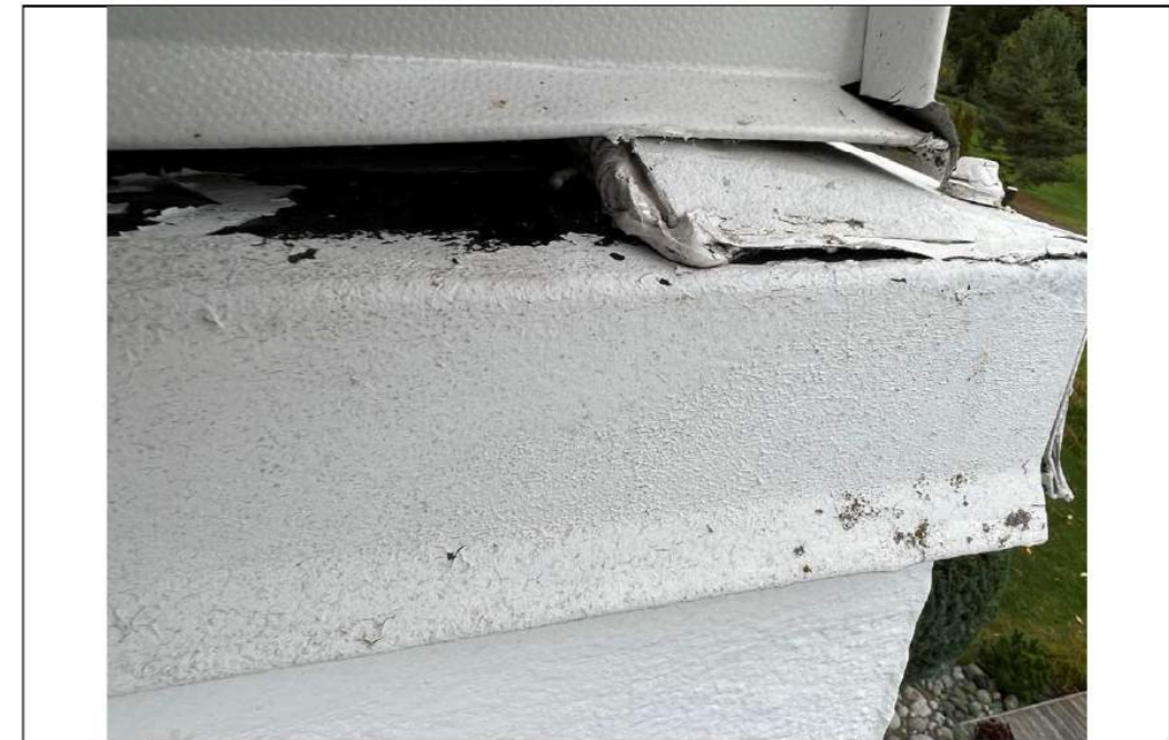
11. Bildet viser at det er lagt beslag med fall over det gamle beslaget. Valgt løsning er ikke tett, og det er brukt fugemasse for å sikre tetthet. Ikke fagmessig utførelse.
