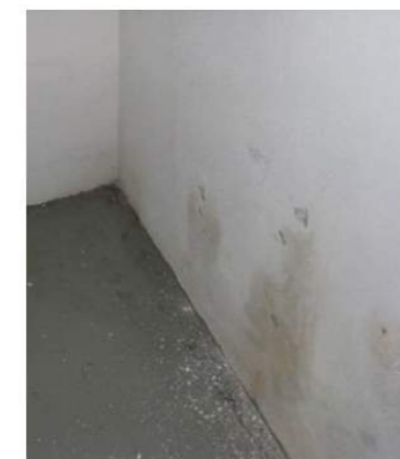
Aktinobakterier vokser ofte på fuktbelastede betongoverflater.
