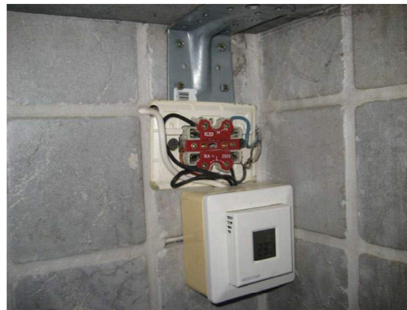
Avvik 51: Ikke fagmessig utførelse.
