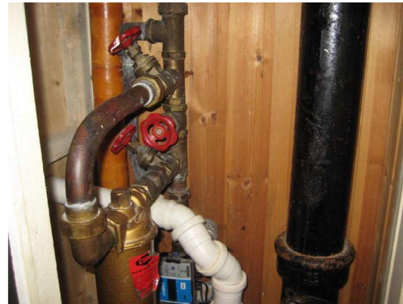
Avvik 23: Manglende utjevningsforbindelser mellom soil, vann og sikringskap.
