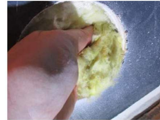
Foto 10. Yttervegg til høyre for vindu. Våt isolasjon i hull o vegg i nedkant.
