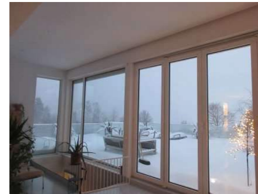
Foto 35. Stuedel mot terrasse. Det skal ikke ha vært lekkasje ved denne delen.
