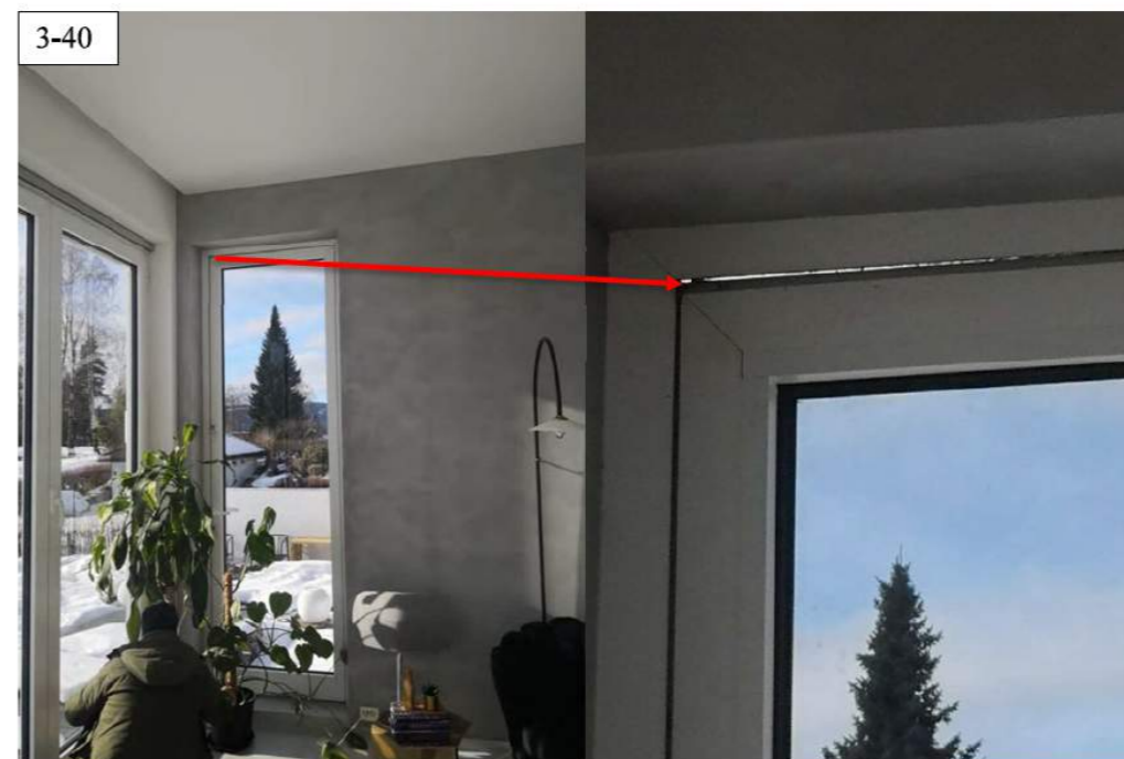
Bildene vise en skjev balkongdør. I lukket stilling kan man se lyset gjennom karmen. Det skal ikke være åpning i dør eller vinduskarmen da dette fører til kald trekk og kondensering samt vanninntrenging.
