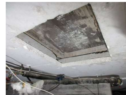
Foto 48. Krypekjeller. Blendet inspeksjonsluke i himling.
