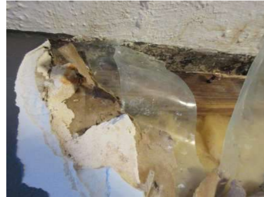
Foto 20. Nærbilde av lekkasjepunkt i overgang støpt himling og yttervegg. Synlig muggvekst på gips og misfarging på troppsvill. Prøve ble tatt med.
