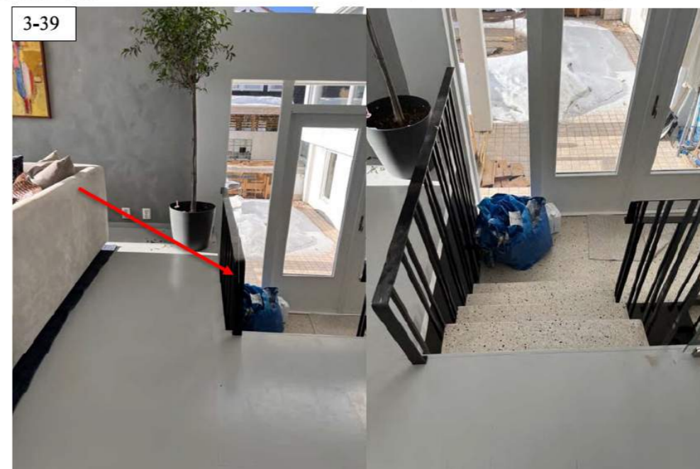
Pil på bildet til venstre viser rekkverk til trapp fra stue i 2. etasje til biljardrom i 1. etasje. Rekkverket er kun 50cm høyt og det er dermed fare for personskaade ved fall da fallhøyden er mer enn 50cm. Det er på det høyeste omtrent 80-90cm fallhøyde. Rekkverk skal være minimum 90cm høyt.
