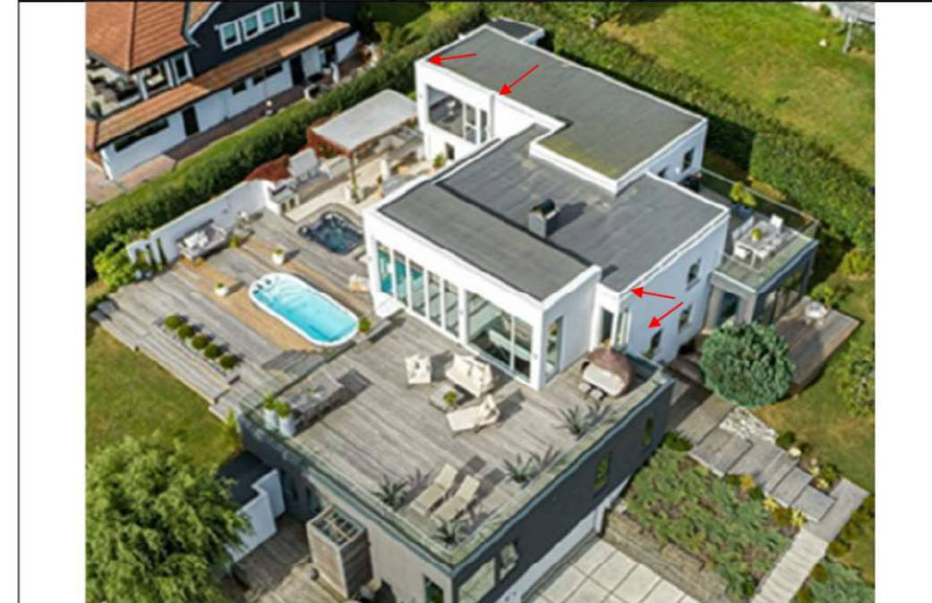
15. Oversiktsbilde av boligen. Beskrevne forhold er markert med pil.
