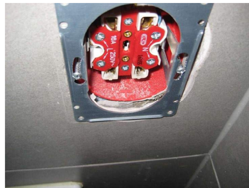
Avvik 5: Koblinger eksponer mot brennbart materiale.
