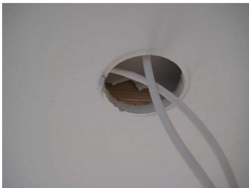
Avvik 1: Defekt kasse skjult i himling. Montert for nærme brennbart materiale.
