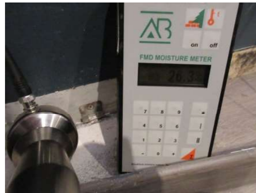
Foto 14. Høy fuktighet (26,3 vekt% trefukt) målt inn i gips/bunnsvill på langvegg bak seng.
