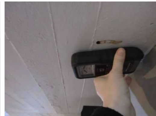
Foto 26. Fuktutslag ble registrert med fuktindikator langs med ytterveggen.
