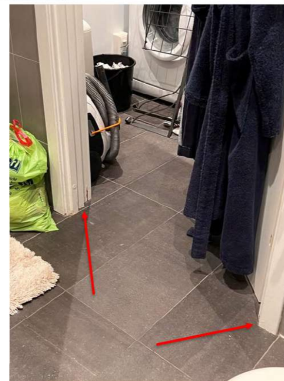
Piler på bildet viser at veggene til vaskerommet er bygget mellom bad og vaskerom. Det er organiske materialer i våtsone som er fuktskadet. Dette er brudd på teknisk forskrift (TEK 10 §13-20). Det er ikke registrert sluk på vaskerommet og lekkasjevann må renne gjennom denne døråpningen før den ledes til sluk i dusjsone. Med tilnærmet manglende fall vil lekkasjevann ledes ut i hele vaskerommet og badet, og dermed ut av døren til badet og ut på kjøkkengulvet.
