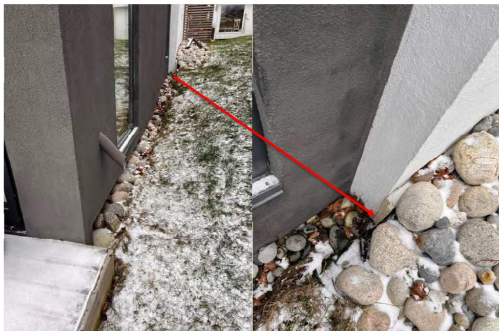
Pil på bildene viser drenering som er avsluttet midt på bygget. Denne dreneringen har ikke god funksjon da den er på en vegg mot en skråning.
