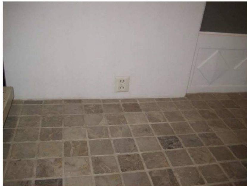
Avvik 33: Ujordet stikk i miljø som krever jordet utførelse.
