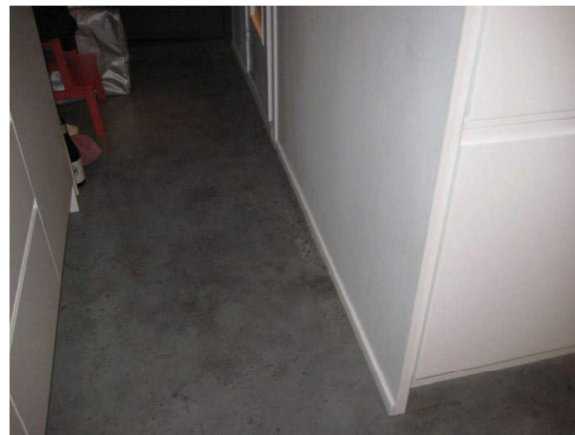
Avvik 44: Referansebilde til termogram over.
