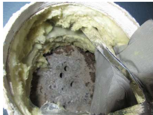
Foto 8. Kondensering registrert på tapen som midlertidig forseglers dampspærren. Hull i øvre del av ytterhjørnet delvis utført (tidligere eier).
