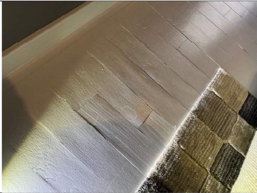
5. Bildet viser fuktskader i parketten. Gulvet er foret opp over betongdekket.
