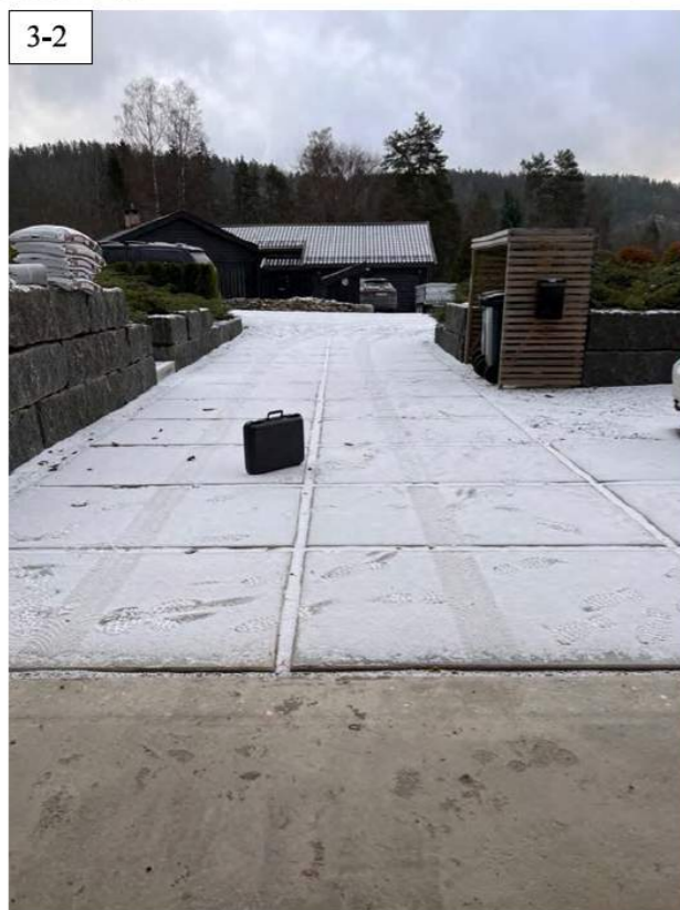
Bildet er tatt fra innside garasje og utover. Bildet viser at terrenget utenfor garasjen heller innover mot porten.
