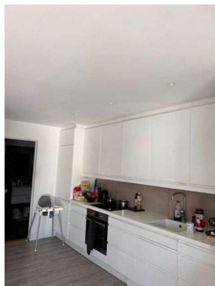
Bildet viser kjøkkenet. Det er foretatt akustikkmåling i leiligheten og hovedenheten. Målingene viser en overskridelse på 3db i henhold til krav i TEK.
