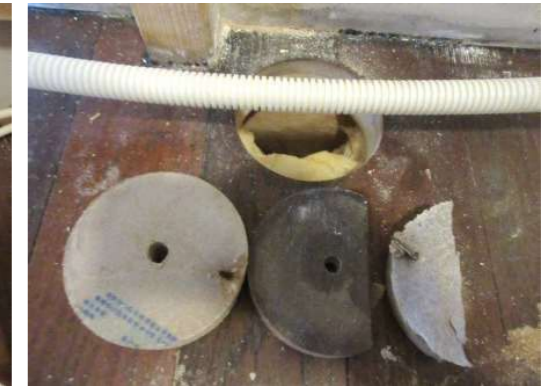
Foto 22. Rustne skruer i tregulvet, som tyder på fuktbelastning ble registrert.
