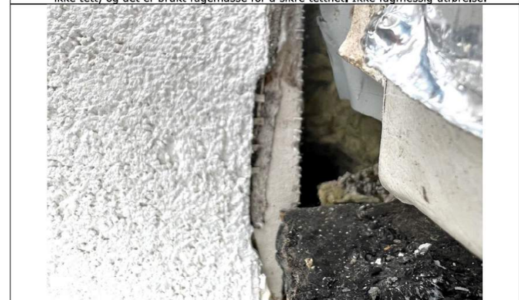
12. Bildet viser manglende totrinns tetting bak beslag mot vest. Her er det åpent rett inn i isolasjonen. Det er ikke avdekket skader innvendig, men utførelsen er ikke fagmessig.
