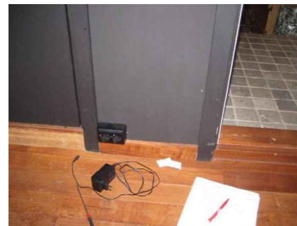
Avvik 24: Blandet installasjon.
