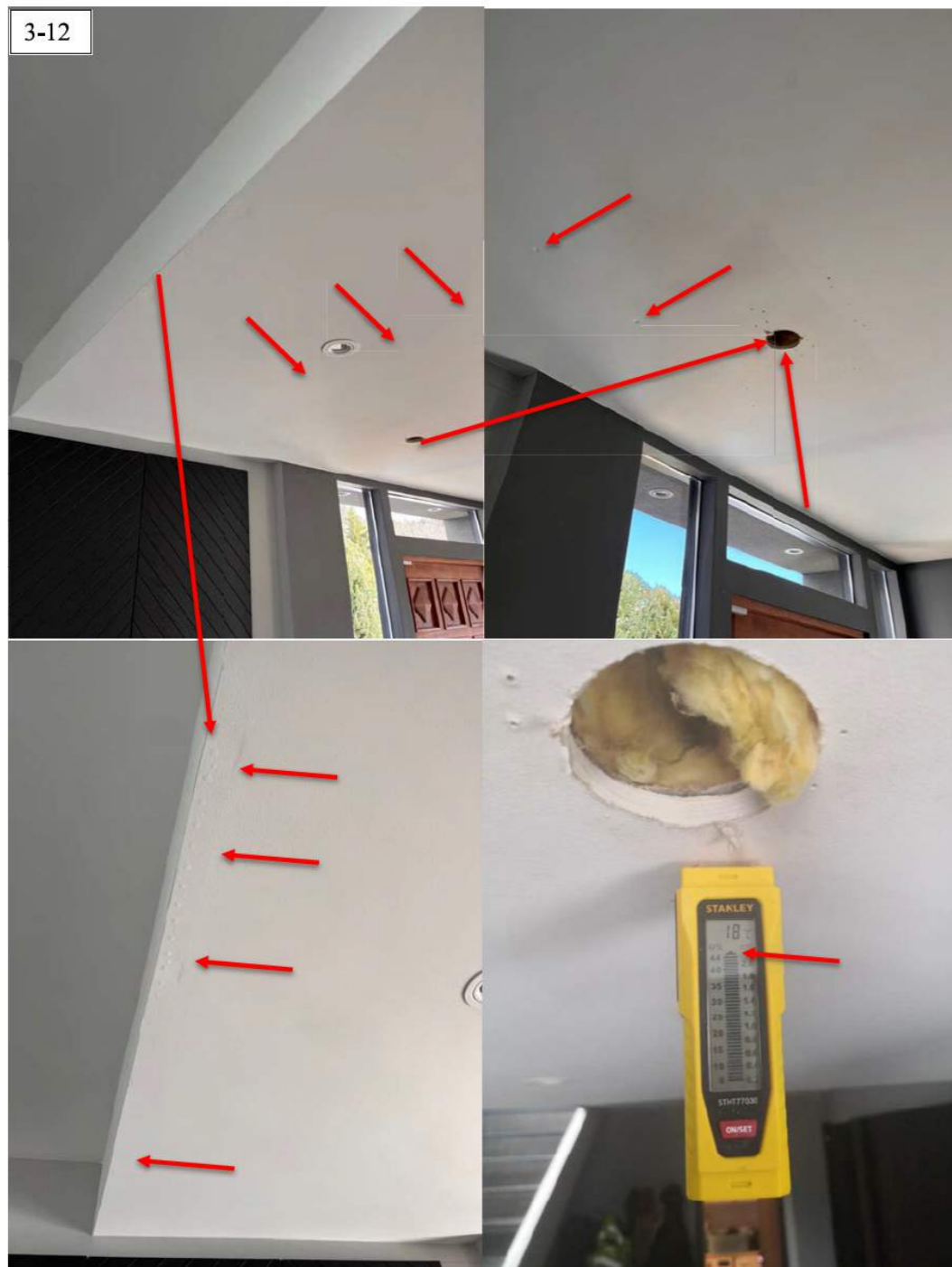
Piler på bilder over viser fuktskade i taket i gangen som følge av vannlekkasje fra utett membran på takterrasse.
