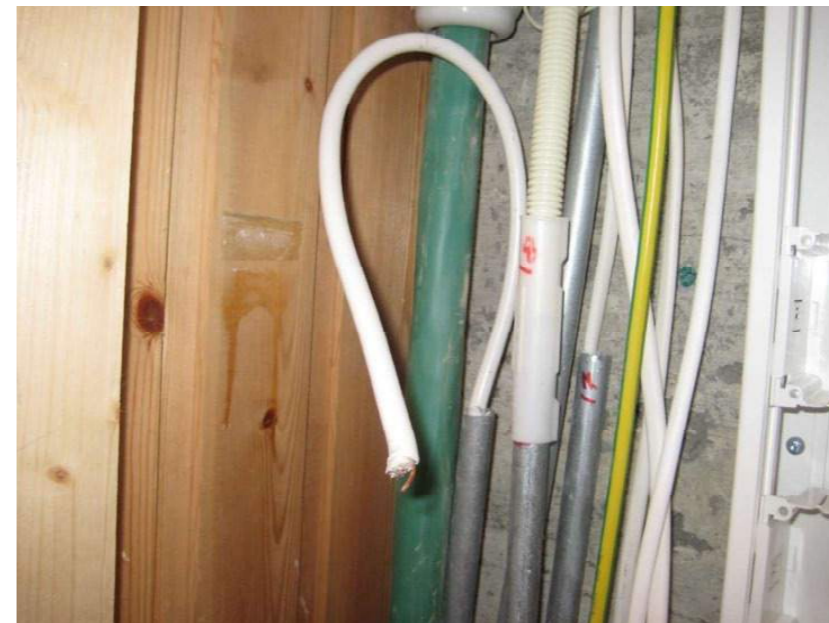
Avvik 16: Metallrør er ikke tilknyttet jord. (Her sees også omtalt kabel i avvik 13 – ikke godkjent innomhus).
