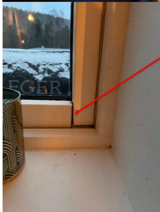
Bilder over viser et vindu på kjøkkenet som har fuktskadet ramme. Glassruten faller ut av rammen dersom vinduet åpnes.
