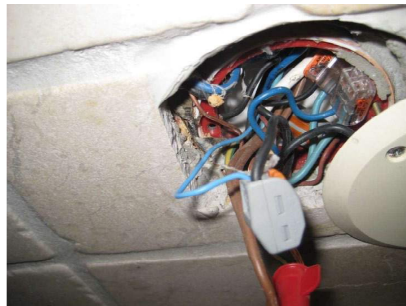
Avvik 30: Ikke fagmessig utførelse.
