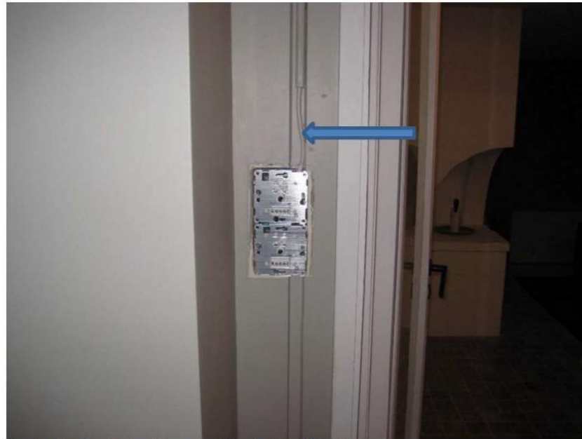
Avvik 32: Ledning ikke godkjent til fast installasjon
