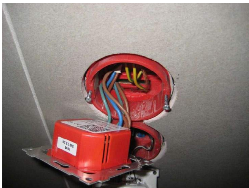
Avvik 6: Koblinger eksponert mot brennbart materiale.
