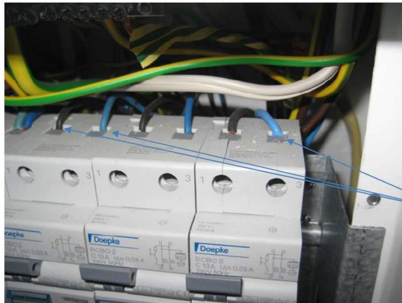
Avvik 17: Lederisolasjon ligger under tilkoblingsklemme. Økt fare for kontaktsvikt.
