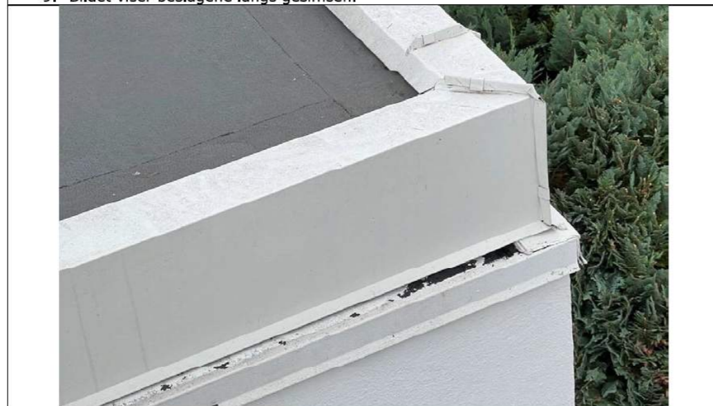
10. De gamle beslagene i underkant av nyere beslag mangler fall, og har ikke tette skjøter.
