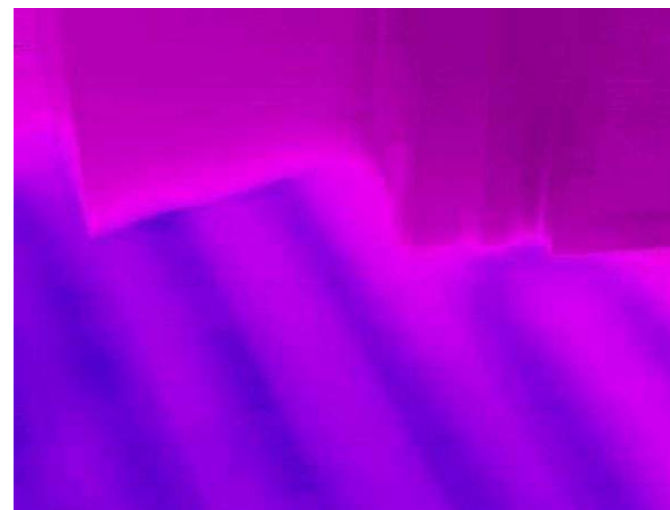
Avvik 26: Varmekabel ikke forlagt etter fabrikantens anvisning.
