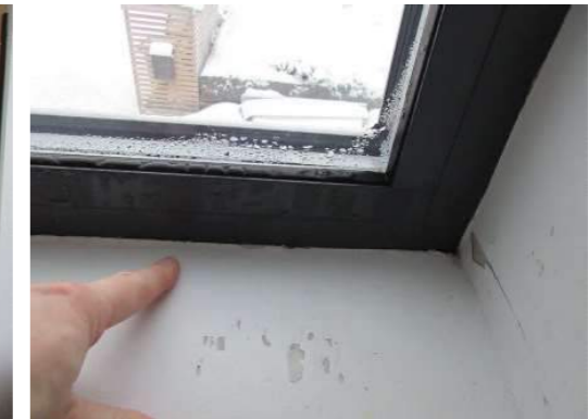
Foto 4. Kondens på alle vinduer. Vinduer av metall.
