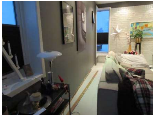
Foto 37. Det har vært lekkasje ved yttervegg bak sofaen. Gulvlisten var derfor demontert.
