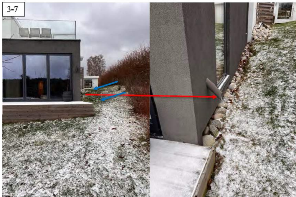
Blå piler på bildet til venstre viser at terrenget heller mot husvegg. Rød pil viser TEK 10 §13-16 viser at terrenget rundt byggverk skal ha fall ut fra husvegg slik at det ikke oppstår skade på bygg som følge av vann som renner inn mot bygget.
