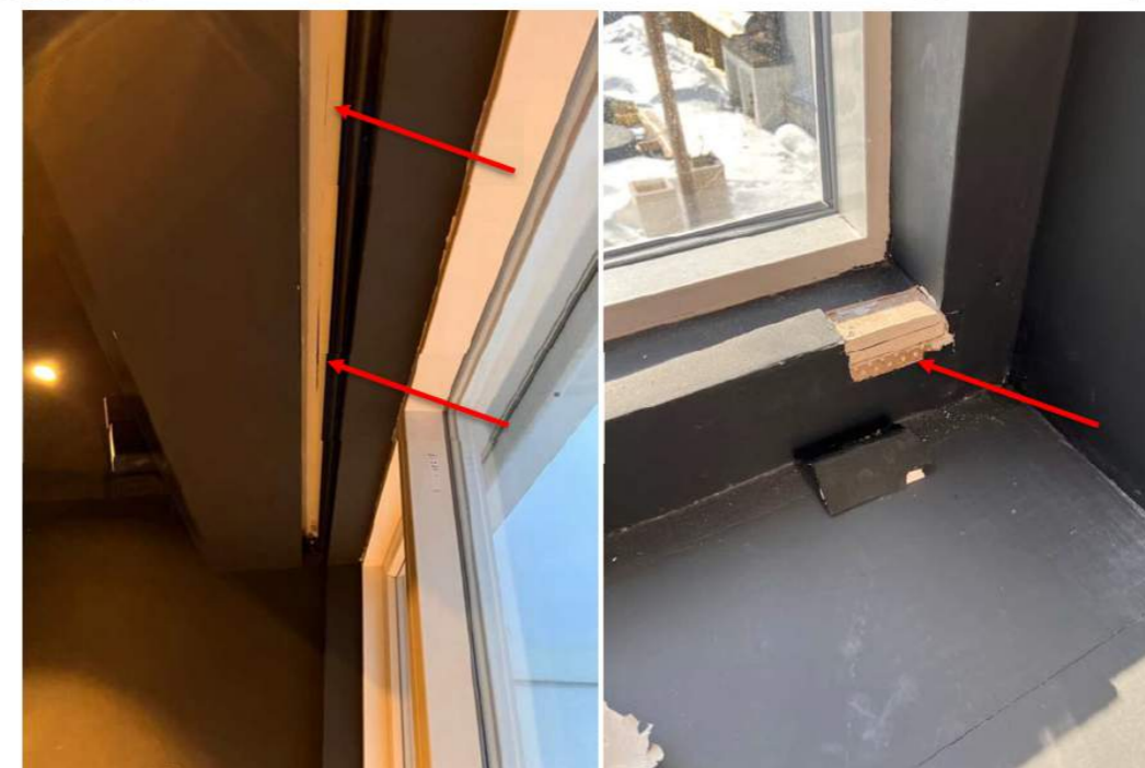
Piler på bilder over viser skader etter vannlekkasje fra utett yttertak.
