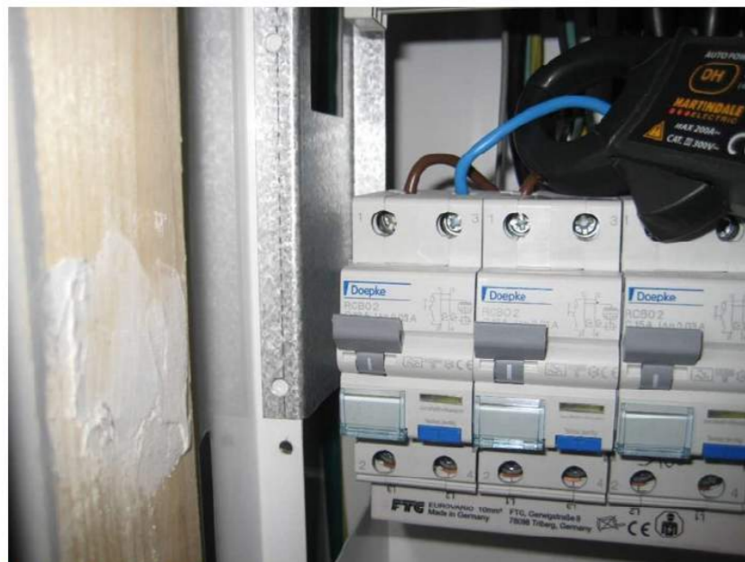
Avvik 18: Kurs 26 overbelastet.
