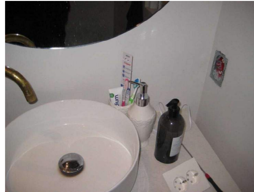
Avvik 34: Ikke fagmessig utført. Koblinger eksponert mot brennbart materiale.
