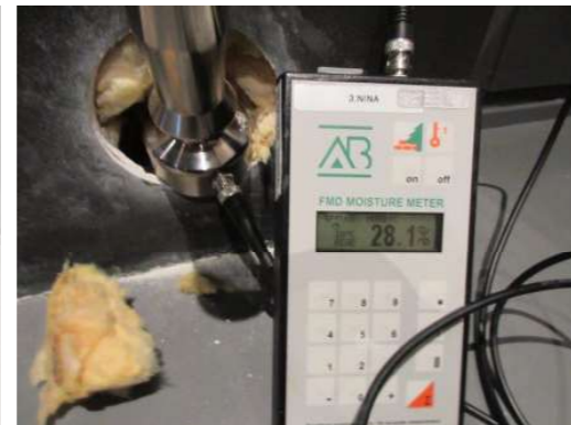
Foto 43. Vått (>28 vekt% trefukt) i svill i innkassing. Isolasjonen var våt og is ble registrert i hullet. Det går trolig et taknedløp her.
