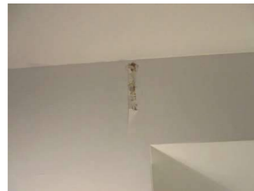
Foto 41. Kjøkken/spisestue. Kontroll i øvre del av yttervegg hvor det ble registrert sprekk viste ikke fuktutslag eller synlige tegn til muggsoppvekst.
