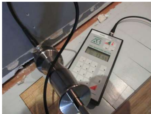
Foto 39. Fuktmåling inn i gipsplate/bunnsvill inn i ytterveggen ved lekkasjeområdet. Tørr ved inspeksjonen (13,5 vekt% trefukt).
