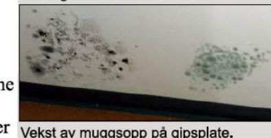
Vekst av muggsopp på gipsplate.
