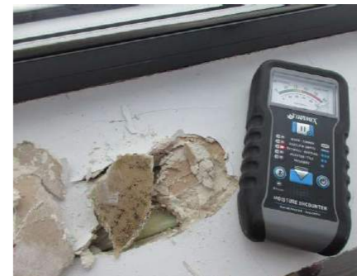
Foto 5. Fuktighet i vinduskarm og muggsoppvekst påvist på undersiden av gipsplate.
