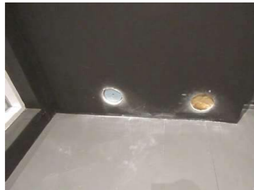
Foto 42. Gjesterom. Hulltaking i nedkant av innkassing ved ytterhjørnet.
