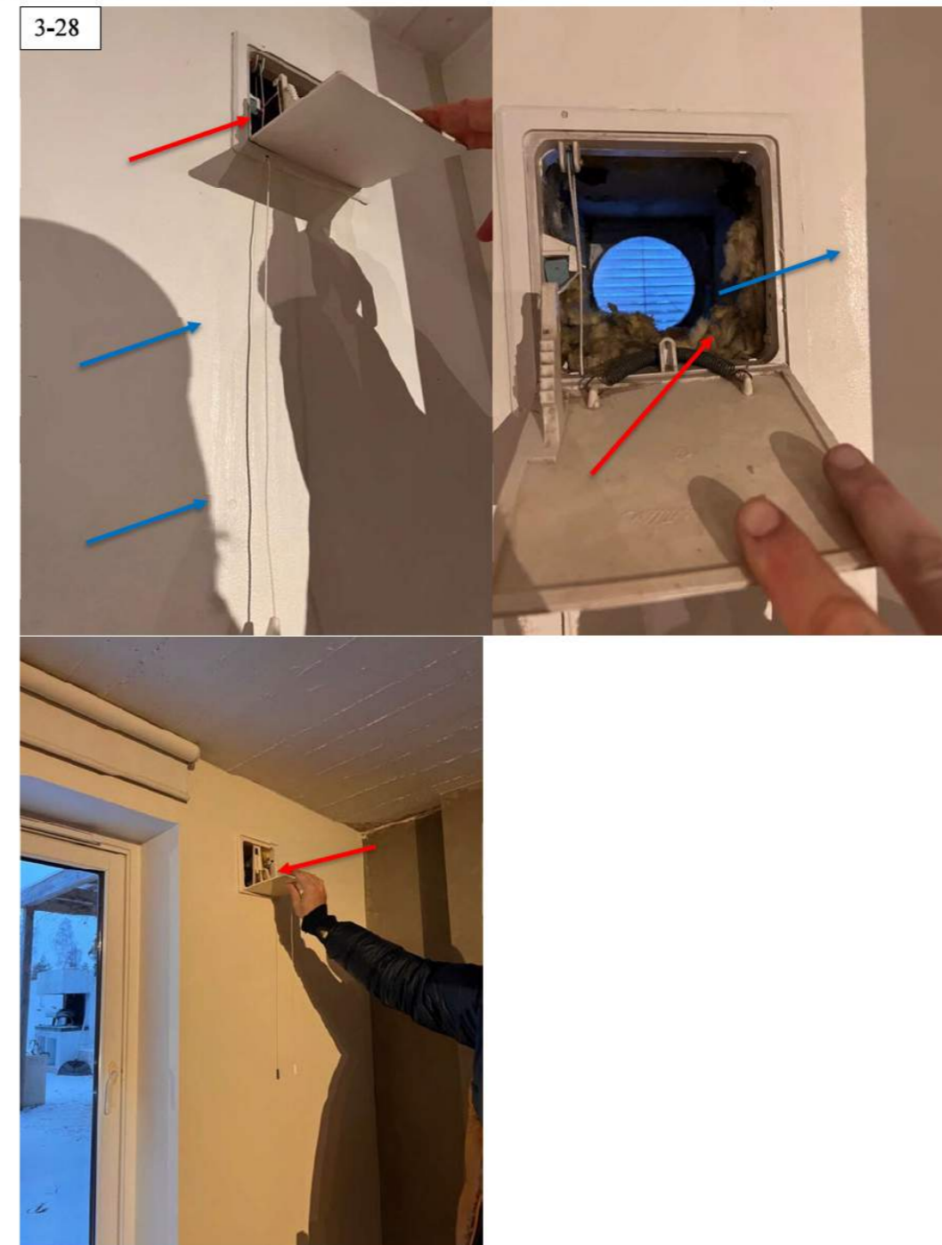
Røde piler på bilder over viser lufterventiler i vegg på trimrommet. Ventilene mangler gjennomføringskanal og er ikke tilstrekkelig tettet mot resten av konstruksjonen. Blå piler viser hvordan det har kondensert på veggene. Rommet har ikke blitt brukt de siste dagene før befarings. Et stort avvik er avdekket her, lik som avvikene i punkt 1. Murvegg er kun isolert på innsiden og skaper dermed kondens i vegg. Med lufteluker i vegg fører det til raskere kondensering og fuktskader i veggene.
