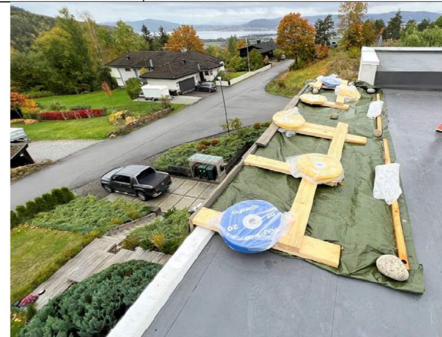
8. Bildet viser hvordan taket ble dekket til for å stanse innsiget. Boligen ligger høyt og er dermed værutsatt.
