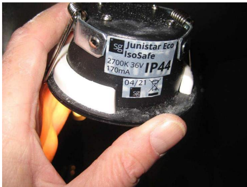
Avvik 51a: Spotter fra april 21. Dokumentasjon mangler.
