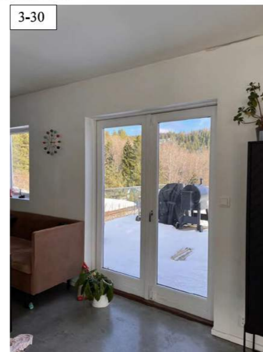
Bildet viser balkongdør på kjøkkenet. Denne døren må justeres da den ikke kan åpnes og lukkes uten makt.
