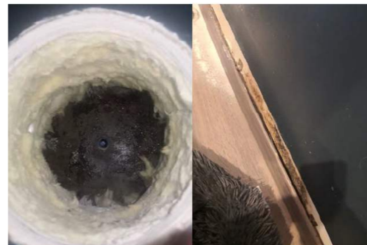
Bildet til venstre viser hullet som er omtalt over, før kjøper laget flere hull i betongen for å undersøke veggtykkelsen. Bildet viser fuktig betongvegg som følge av kondensering. Bildet til høyre viser sopp bak gulvlist som følge av kondensering av yttervegg og manglende ventilering av rommet.
