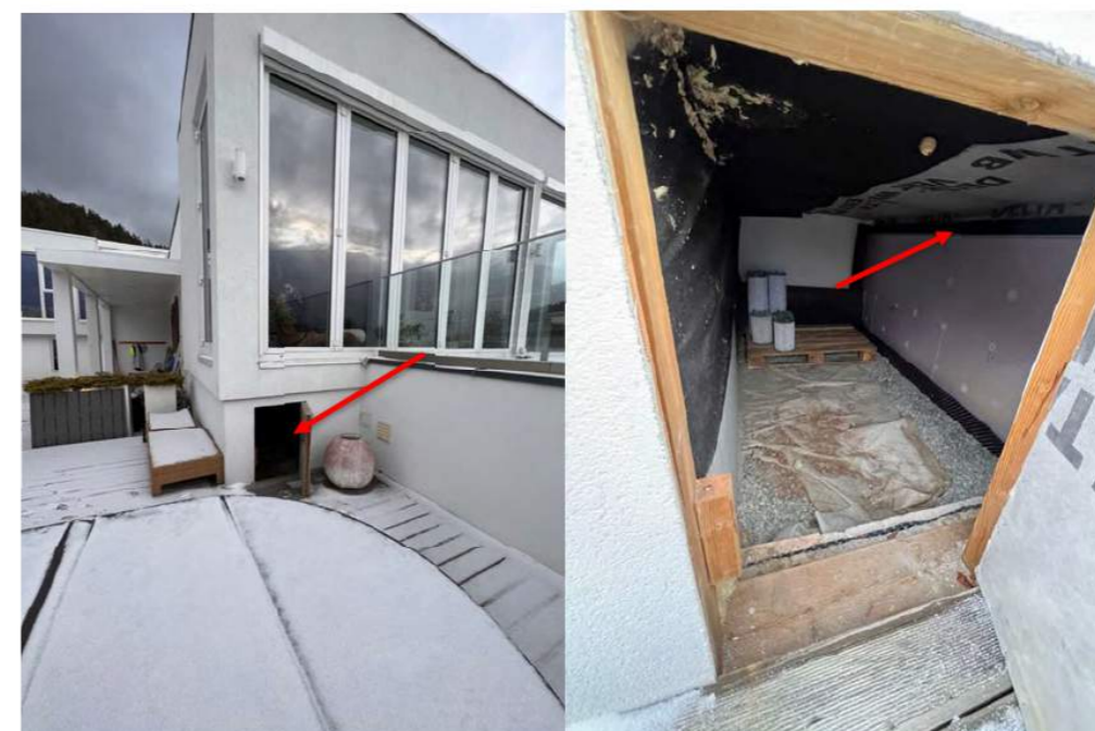
Pil på bildet til venstre viser en bod med tilgang fra terrassen bak huset. Pil på bildet til høyre viser at isolasjon på en yttervegg av betong er avsluttet for kort. Denne veggen er deler av en kjellervegg.
