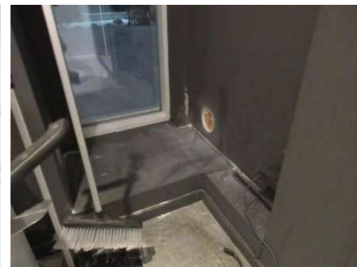
Foto 45. Gang utenfor. Ikke tegn til misfarging registrert via inspeksjonshull i delevegg.
