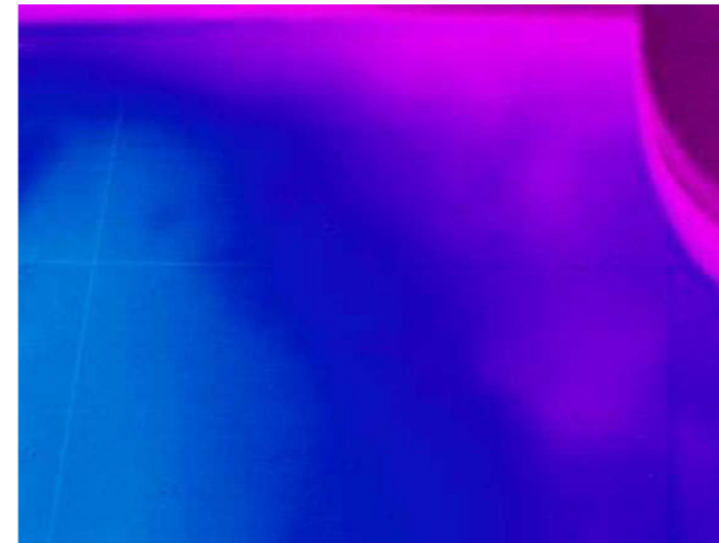
Avvik 35: Dårlig støp hindrer varmekabel i å avgi varme til omgivelsene. Ikke fagmessig utført.
