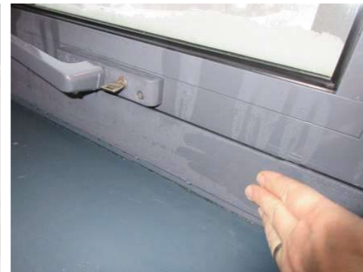
Foto 15. Hovedsoverom. Kondens på vinduet og fuktutslag på gipsplate i vinduskarm.
