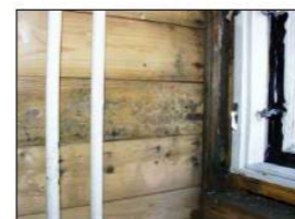
Muggsoppskader som følge av oppfuktning etter brannslukking.
