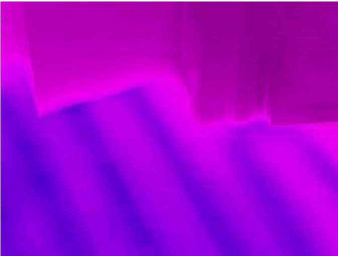
Avvik 26: Varmekabel ikke forlagt etter fabrikantens anvisning.
