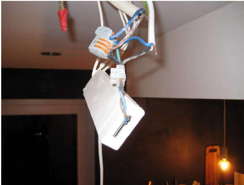
Avvik 45: Ikke fagmessig utførelse.
