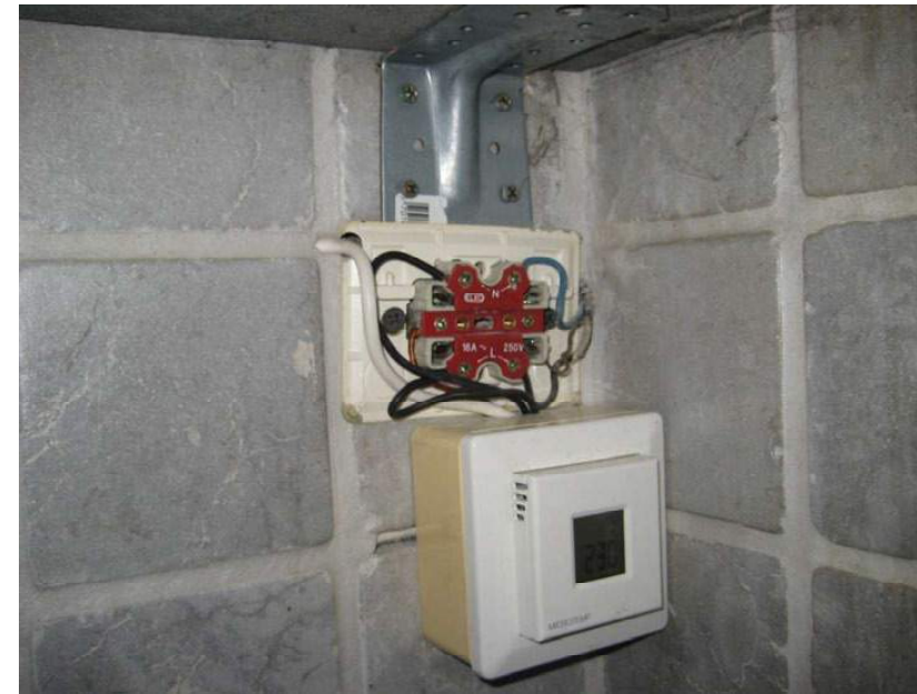
Avvik 51: Ikke fagmessig utførelse.
