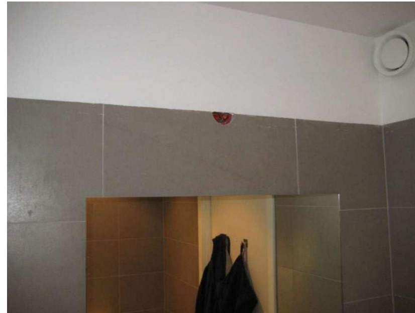
Avvik 3: Veggboks ikke tilgjengelig.
