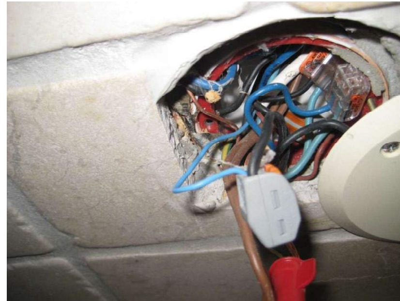
Avvik 30: Ikke fagmessig utførelse.
