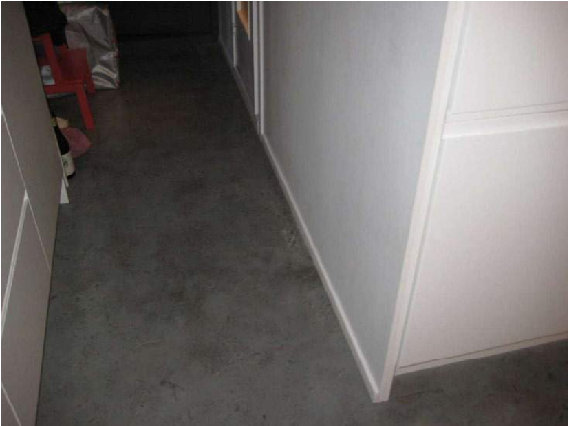
Avvik 44: Referansebilde til termogram over.
