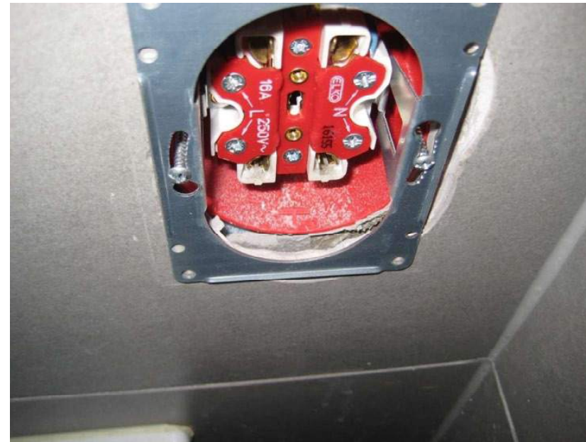
Avvik 5: Koblinger eksponert mot brennbart materiale.
