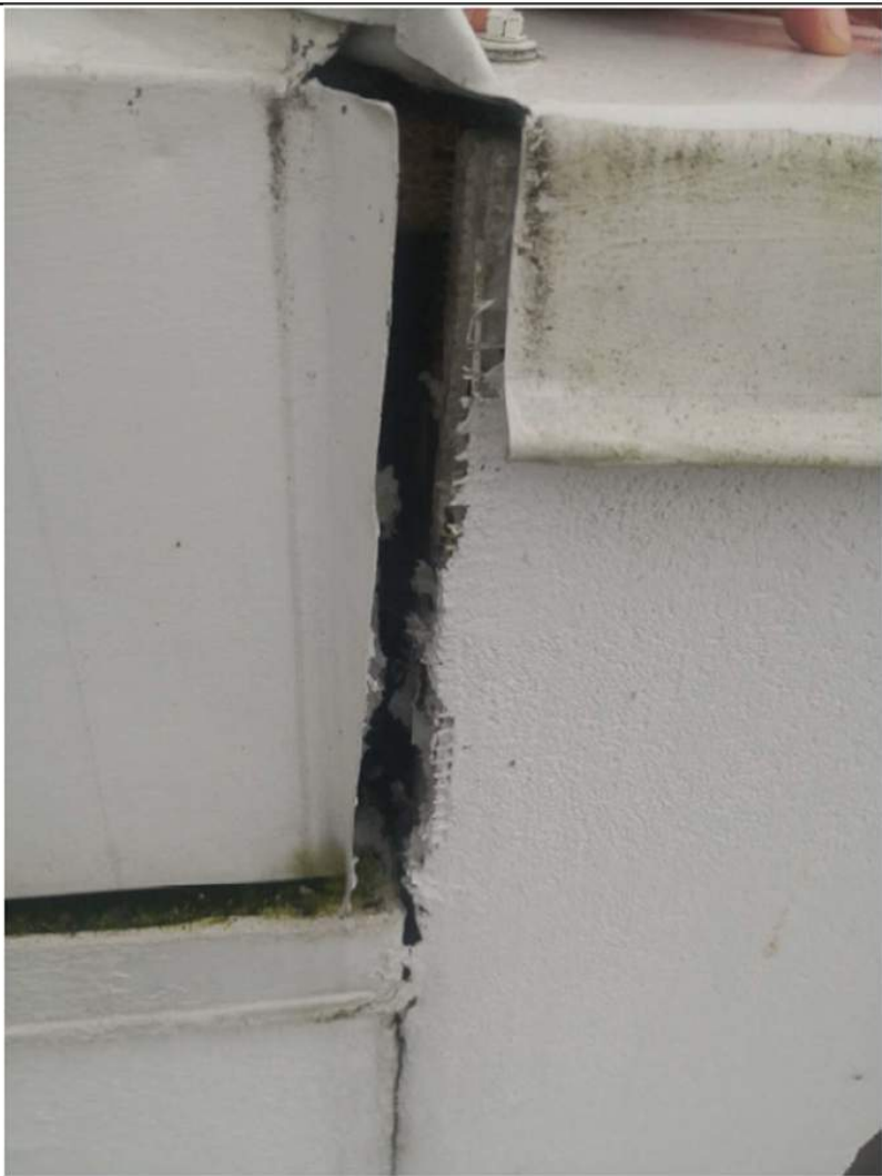
13. Bildet viser utett løsning ved hjørne nordvest.
