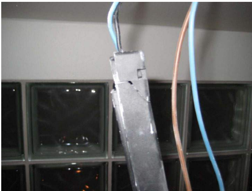
Avvik 28: Defekt trafo.
