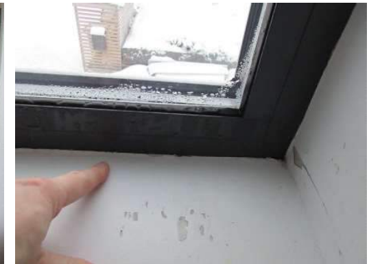
Foto 4. Kondens på alle vinduer. Vinduer av metall.
