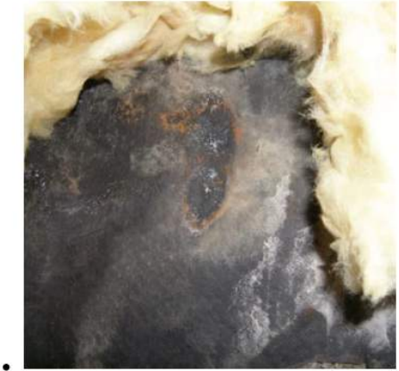
Aktinobakterier på forhudningspapp i en utlekt kjellervegg
