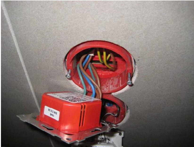
Avvik 6: Koblinger eksponert mot brennbart materiale.
