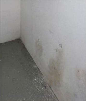
Aktinobakterier vokser ofte på fuktbelastede betongoverflater.
