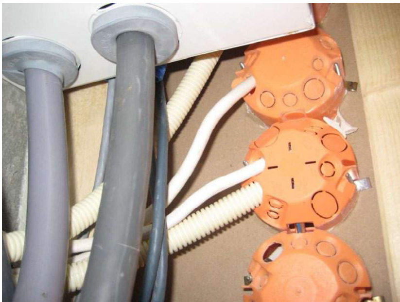
Avvik 22: Ikke fagmessig utført.
