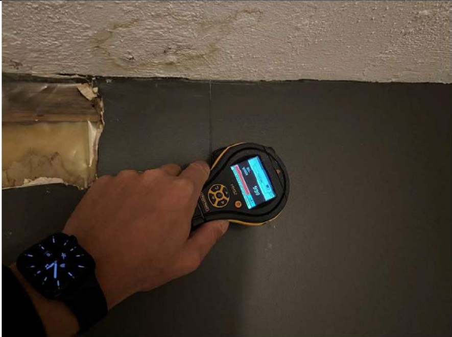
2. Bildet viser fuktutslag i vegg
