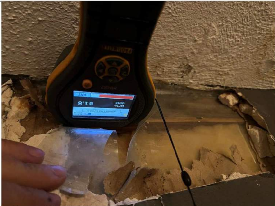
3. Bildet viser fuktmåling i toppsvill.
