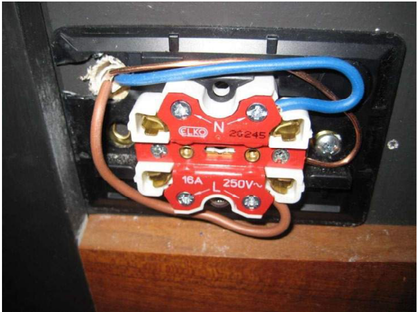
Avvik 25: Udokumentert stikkontakt med produksjonsår 2020, uke 24, dag 5
