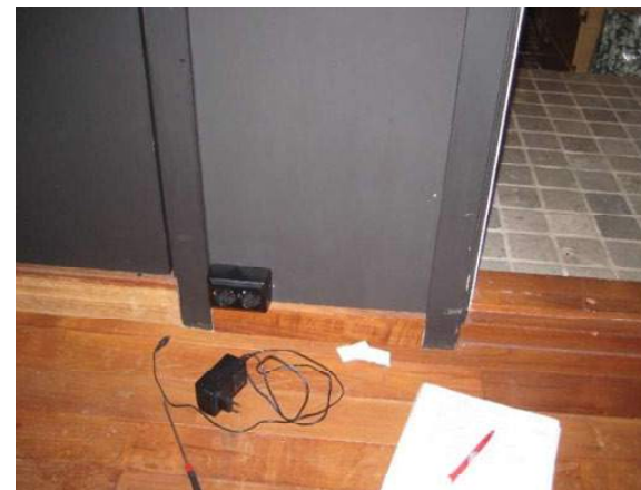
Avvik 24: Blandet installasjon.
