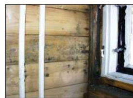
Muggsoppskader som følge av oppfukting etter brannsløkking.
