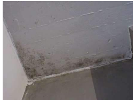
Foto 25. Nærbilde av muggsoppvekst ved hvert ytterhjørne.
