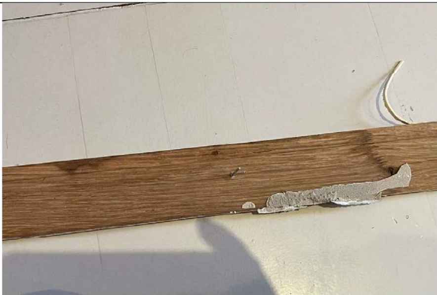
7. Bildet viser fuktmerker på fotlisten.
