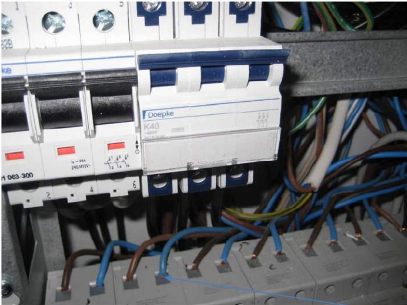
Avvik 40: Kabelisolasjon ligger innunder tilkoblingsklemme
