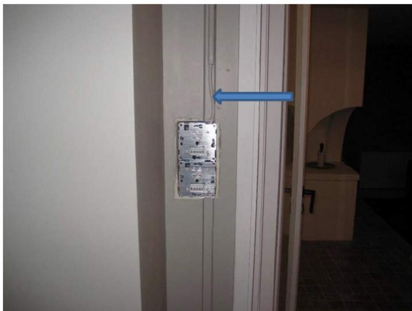
Avvik 32: Ledning ikke godkjent til fast installasjon
