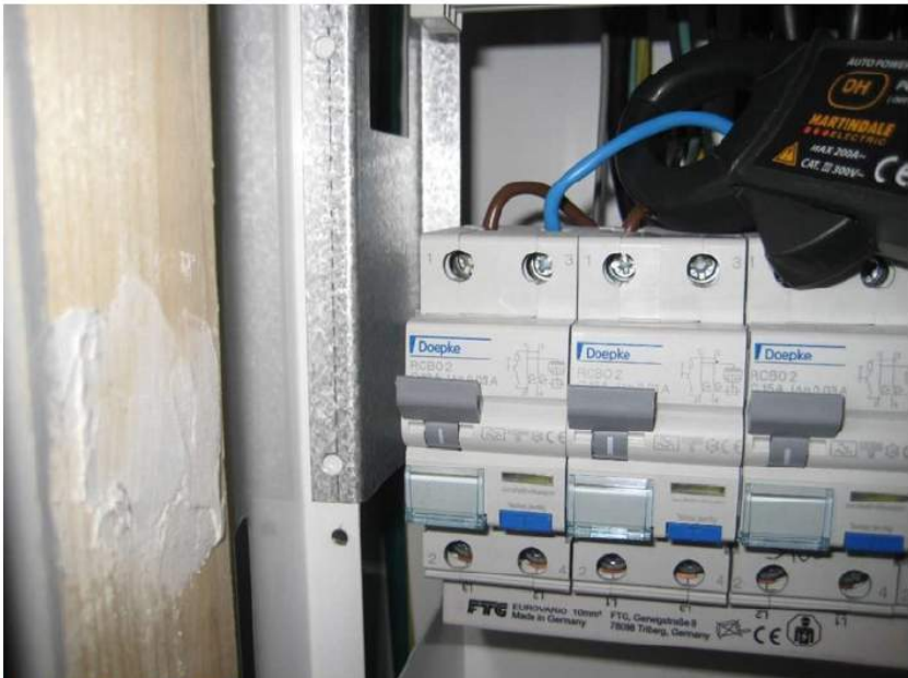
Avvik 18: Kurs 26 overbelastet.
