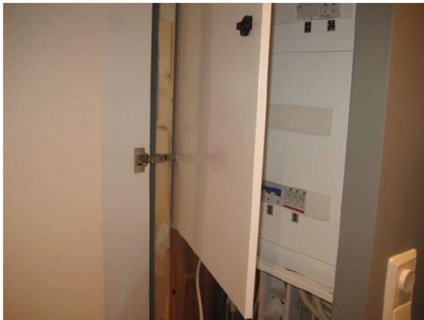
Avvik 12: Sikringsskap er ikke tilgjengelig.
