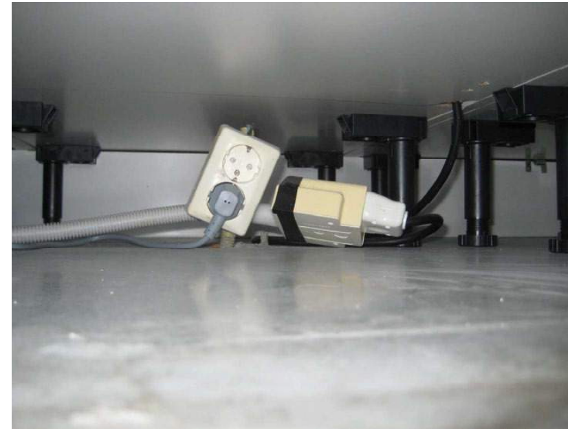
Avvik 49 og 50: Ikke fagmessig utførelse.
