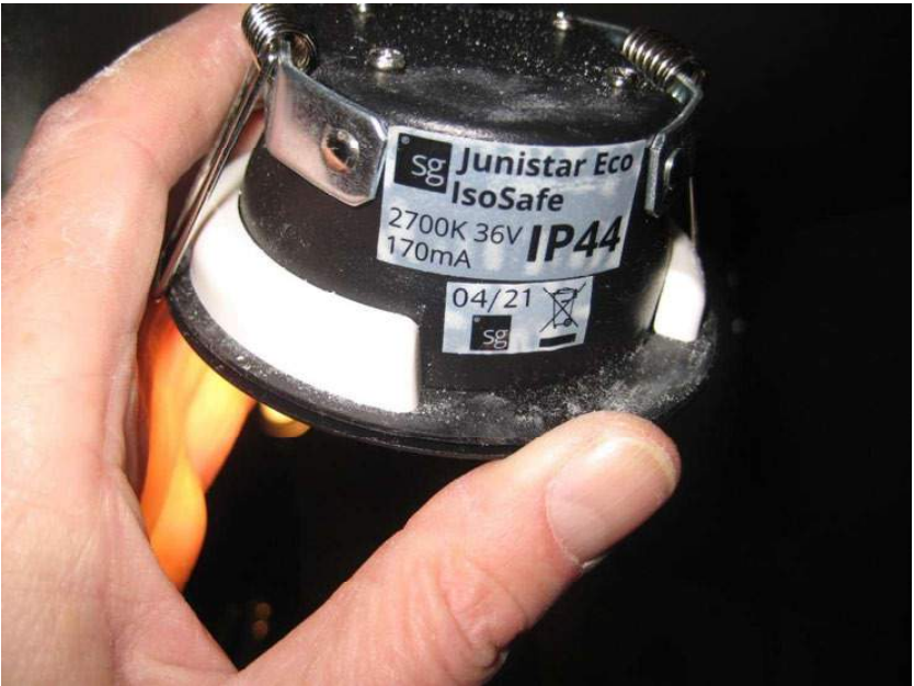
Avvik 51a: Spotter fra april 21. Dokumentasjon mangler.
