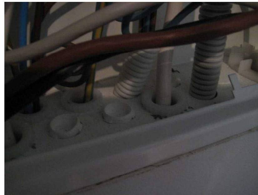
Avvik 10: Rørinnføringer er ikke korrekt avsluttet mot skap.
