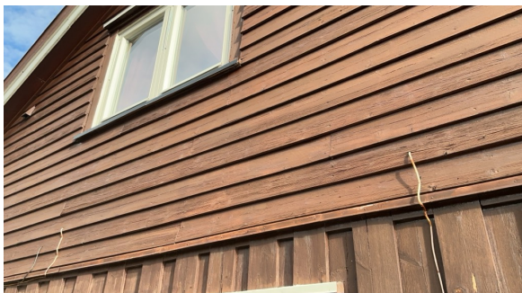
Værslitt og oppsprukket bordkledning
