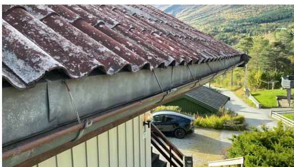
Rust på takrenne og rennekroker
