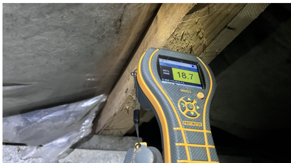
Fuktsøk i bjelkelaget
