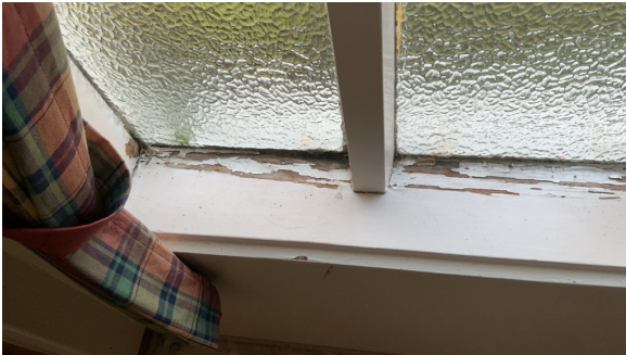
Vindu i vindfanget med mye slitasje
