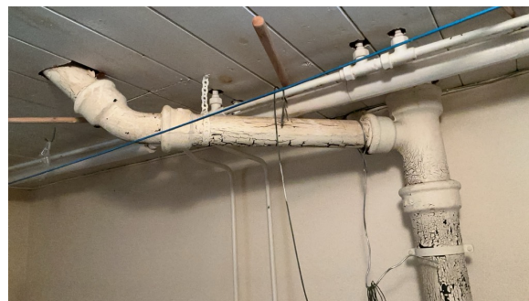
Avløp fra 1. etasjen
