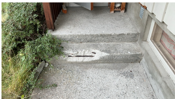
Skader i betongen
