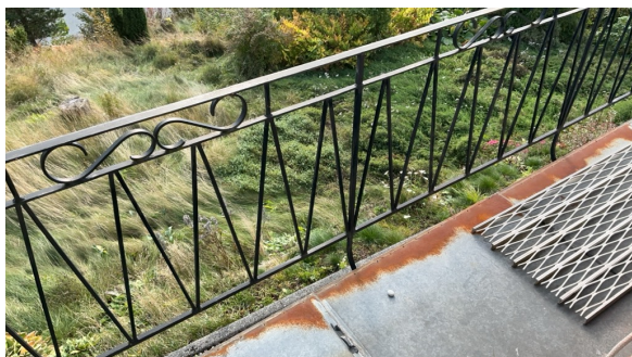
Balkongen med rust på rekkverk og tekking
