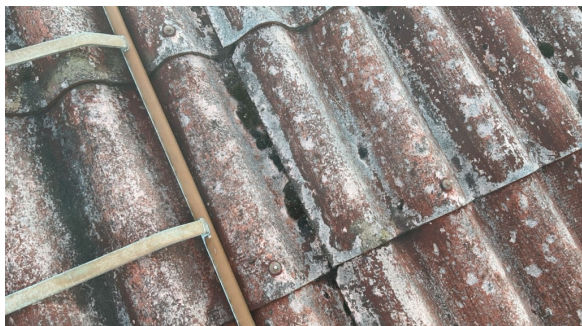
Mose og slitasje
