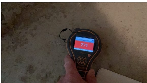
Fuktsøk på gulvet i vaskerommet
