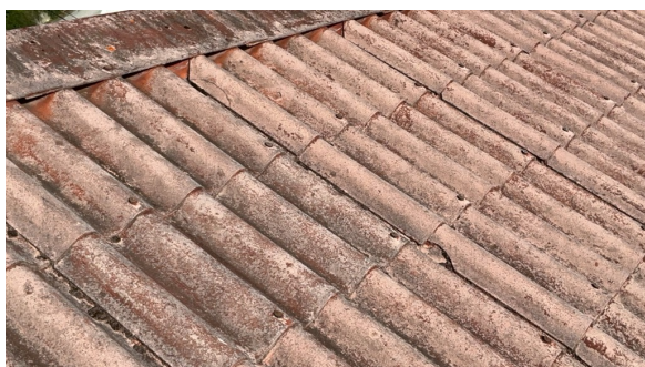
Sprekker i noen takstein
