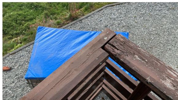
Sprekker i rekkverket på verandaen
