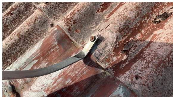
Løs innfesting på luftehatt
