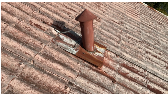
Mye rust på luftehatt
