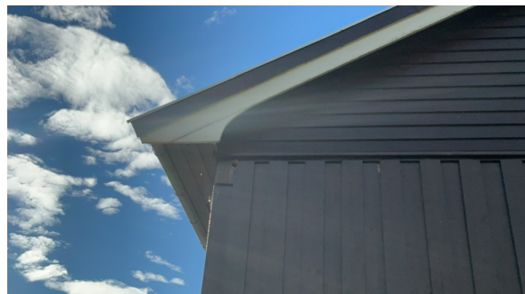
Hull i bordkledningen. Sannsynlig etter en hakkespett
