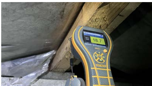
Fuktsøk i bjelkelaget
