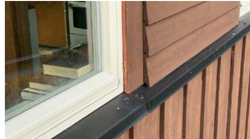
Vinduet på stuen har hakk i karmen forårsaket av fugl.
