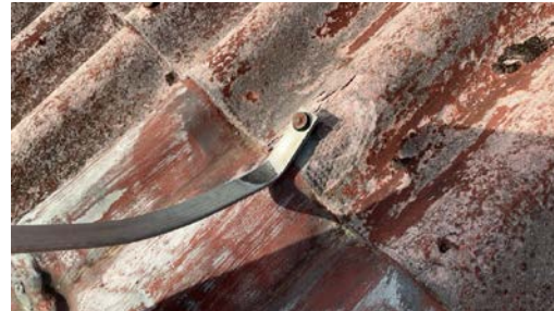
Løs innfesting på luftehatt
