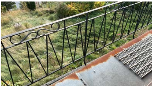
Balkongen med rust på rekkverk og tekking
