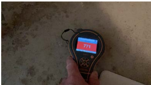
Fuktsøk på gulvet i vaskerommet
