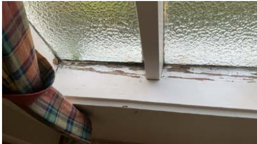
Vindu i vindfanget med mye slitasje
