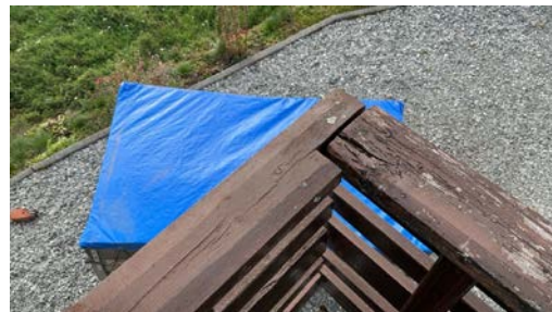
Sprekker i rekkverket på verandaen
