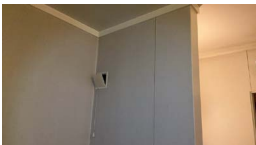
Sprekker i veggtapetet.
