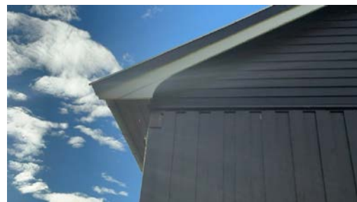
Hull i bordkledningen. Sannsynlig etter en hakkespett
