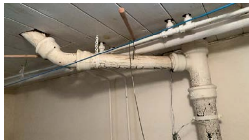
Avløp fra 1. etasjen
