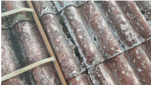
Mose og slitasje
