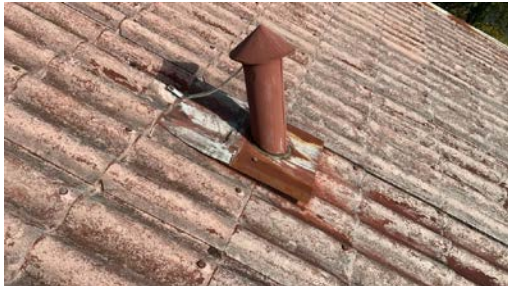
Mye rust på luftehatt
