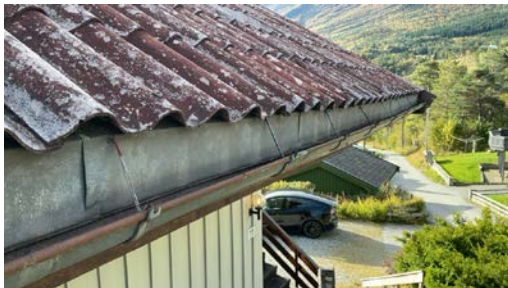
Rust på takrenne og rennekroker
