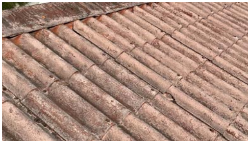
Sprekker i noen takstein
