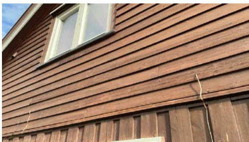
Værslitt og oppsprukket bordkledning
