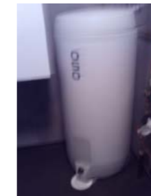
Bereder er plassert på teknisk rom/bod
