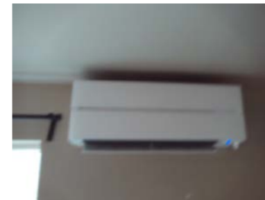
Varmepumpe i stue.
