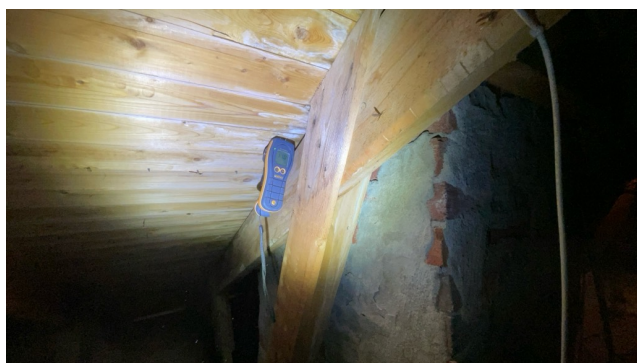
Fuktmåling pipeveksling (noen skjolder)
