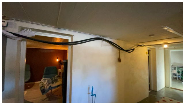
Uklamrede rør kjellergang
