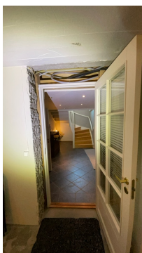
Uferdig rundt dør til "grovkjeller"
