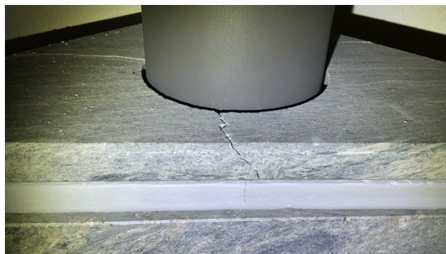
Sprekk toppplate peisovn kjeller
