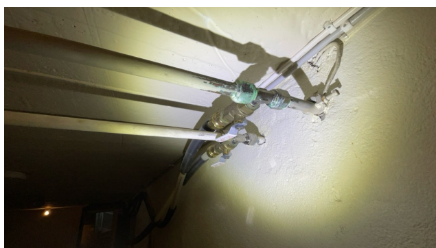
Irrt utett kobling kjellergang (mindre drypp)
