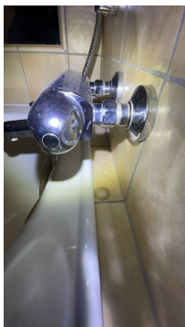
Drypp kobling badekarbatteri (mindre drypp)
