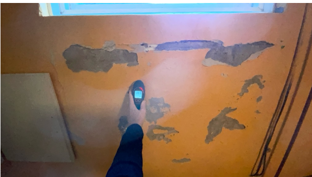
Fuktvandring/flass åpen mur
