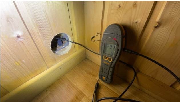
Hulltagning- 24 vekt% fukt og plastfolie i påforingskonstruksjon
