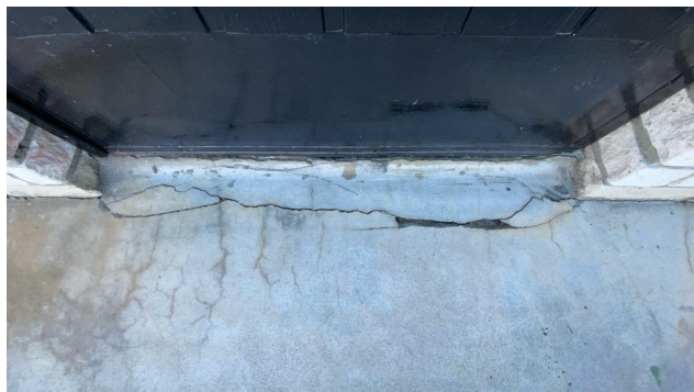
Oppsprekk betong mot dør
