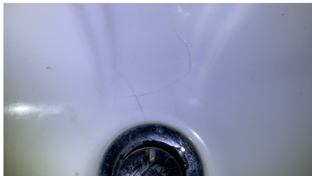
Sprekk/stjerne i servant ved bunnventi
