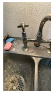
Lekkasje rundt gammel kran ved åpning snekkerbod
