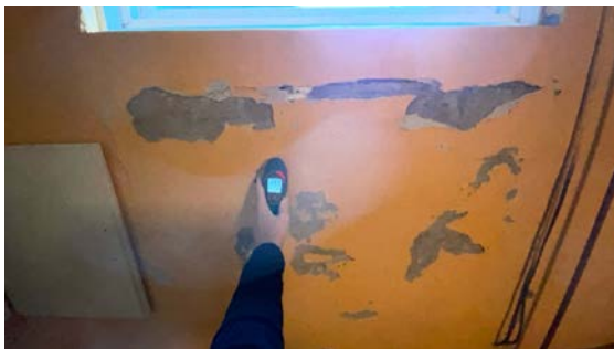
Fuktvandring/flass åpen mur
