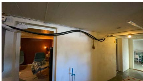
Uklamrede rør kjellergang
