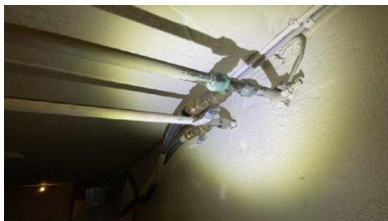
Irret utett kobling kjellergang (mindre drypp)
