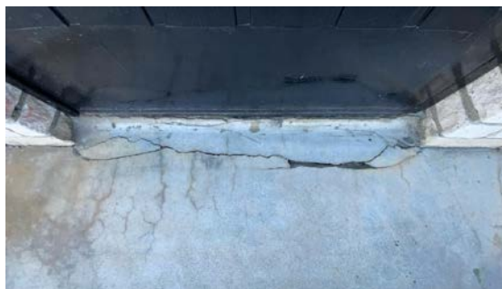
Oppsprekk betong mot dør
