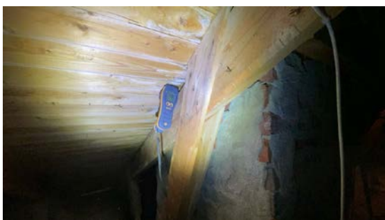
Fuktmåling pipeveksling (noen skjolder)
