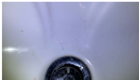
Sprekk/stjerne i servant ved bunnventil
