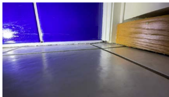
Litt oppsprekk i silikon mot gulv
