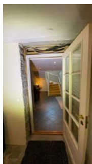
Uferdig rundt dør til "grovkjeller"
