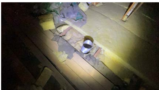
Ventilasjonsrør ikke i bruk på loft
