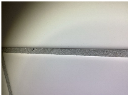
Lite riss i flisfuge i dusjsone.
