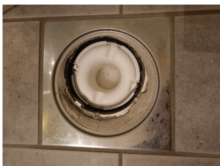
Sluk i dusj, slukmansjett er ikke mettet med membran.
