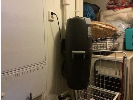
Sentralstøvsuger lokalisert på bod i 2. etasje.
