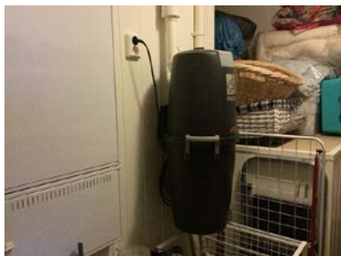
Sentralstøvsuger lokalisert på bod i 2. etasje.
