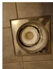
Hjelpesluk, slukmansjett er ikke mettet med membran.
