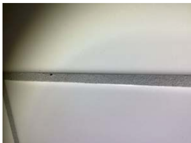
Lite riss i flisfuge i dusjsone.
