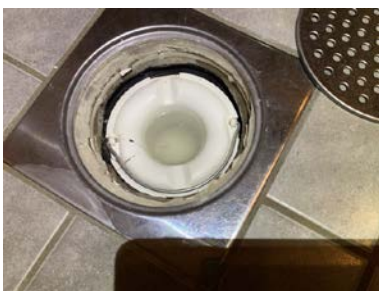
Sluk i dusj, slukmansjett er ikke mettet med membran.
