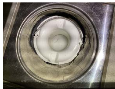
Hjelpesluk, slukmansjett er ikke mettet med membran.
