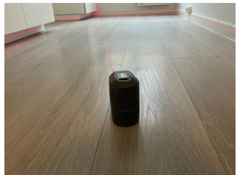
Nivellering kjøkken, avvik ca. 10-20 mm
