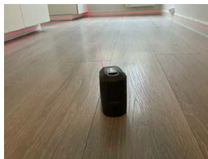
Nivellering kjøkken, avvik ca. 10-20 mm
