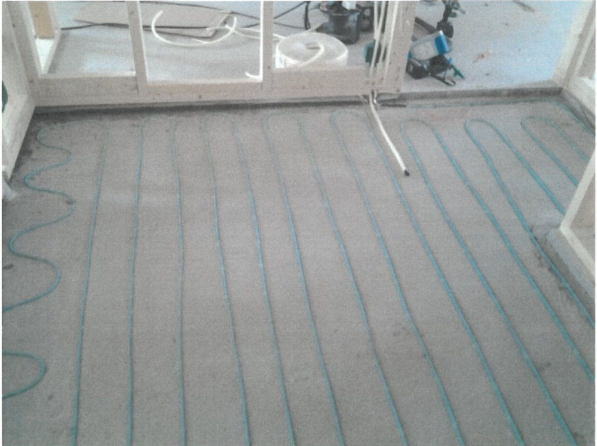
Skjema 'Varme ©Øglend Systems'. Filnavn: 20160819_112414.jpg.
