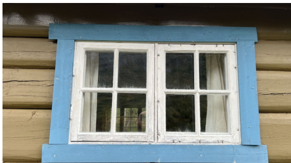
Stor slitasje på vinduene
