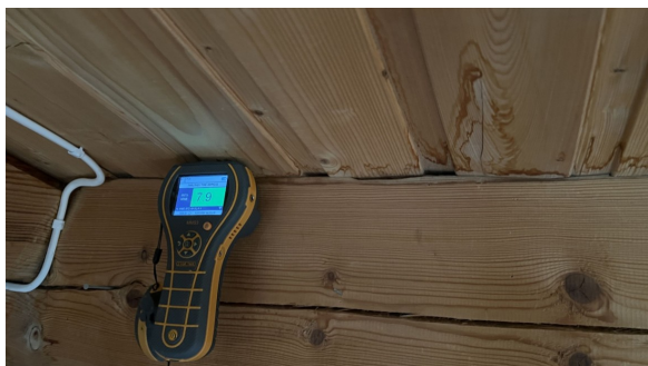
Fuktsøk på eldre fuktmerke
