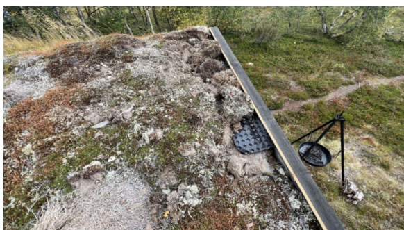
Skader i plastunderlaget
