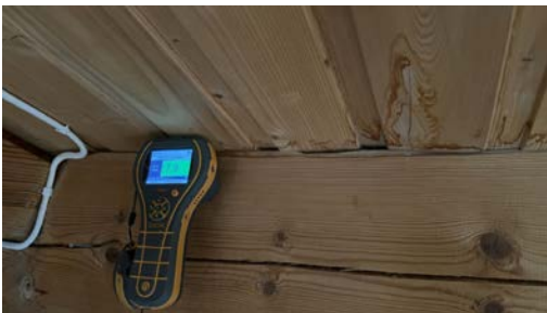
Fuktsøk på eldre fuktmerke
