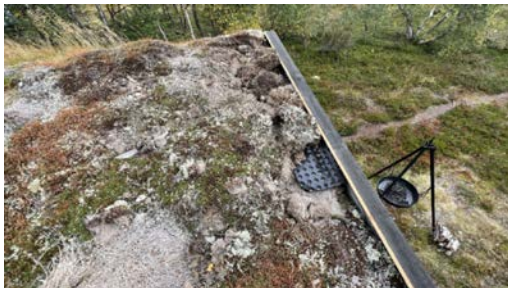
Skader i plastunderlaget
