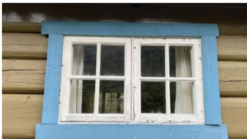
Stor slitasje på vinduene
