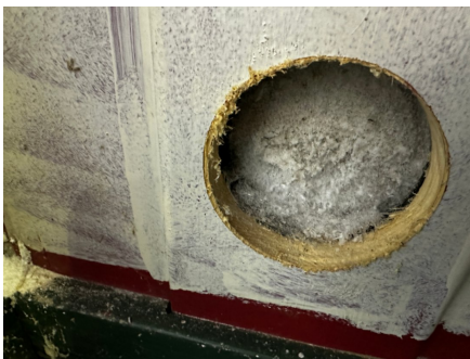
Saltutslag på betong yttervegg
