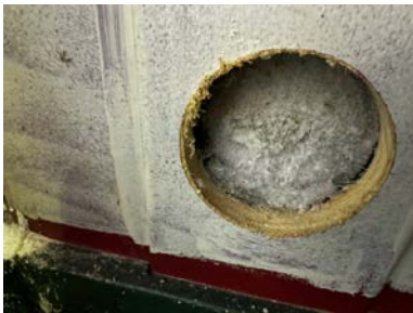
Saltutslag på betong yttervegg
