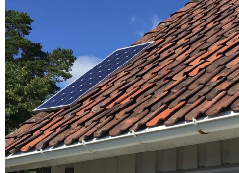
Solcelle på tak.
