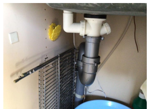
Enkelt avløp fra kjøkken.
