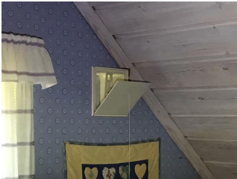
Eksempel på montert ventil i vegg.
