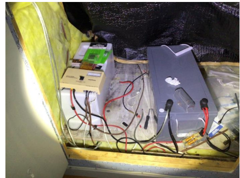
Utstyr til solcelleanlegg.
