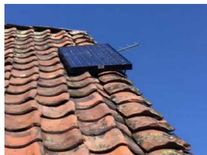
Solcelle på tak.
