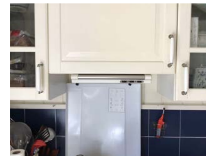
Montert avtrekk over komfyr.
