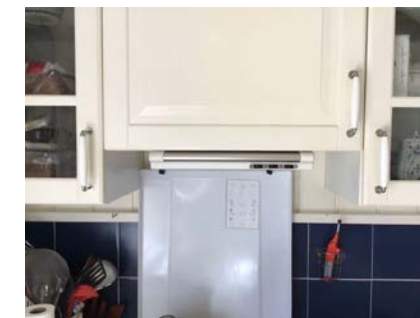
Montert avtrekk over komfyr.
