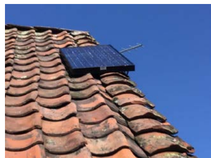
Solcelle på tak.
