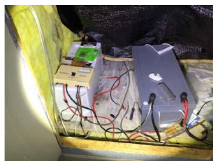
Utstyr til solcelleanlegg.
