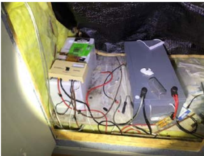
Utstyr til solcelleanlegg.
