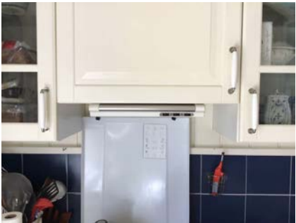
Montert avtrekk over komfyr.
