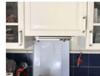
Montert avtrekk over komfyr.
