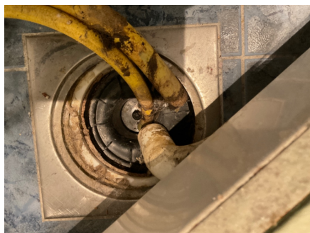
Sluk under dusjkabinett.
