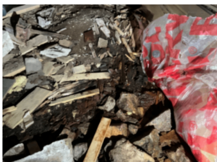
Tilsig av fukt i krypkjeller
