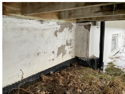
Sprekker og riss i grunnmur.
