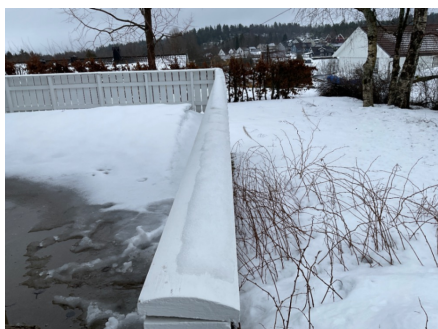
Rekkverk med skjevheter.
