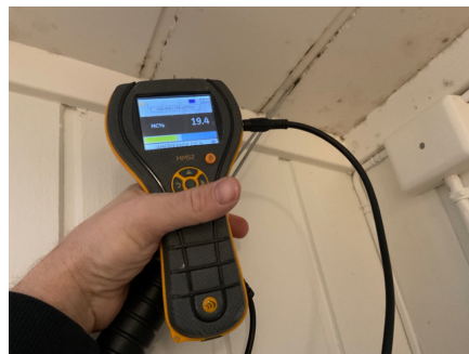
Fuktmåling på plater som har svertesopp.
