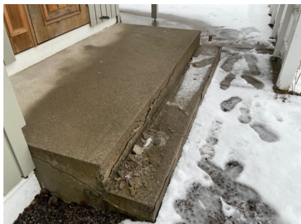
Pussavskalling på trapp.
