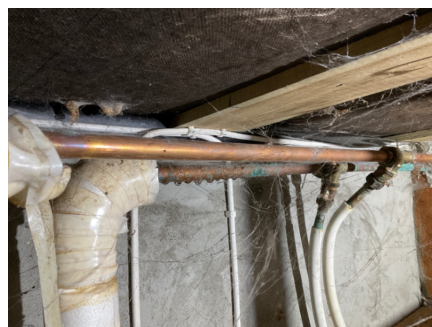
Kondensering på vannrør i krypkjeller.
