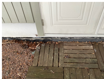
Skader på utvendig fuktsikring av grunnmur.
