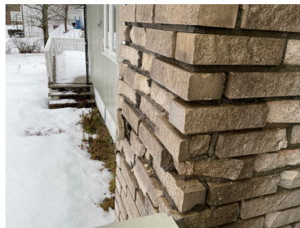
Ødelagte steiner på pipen
