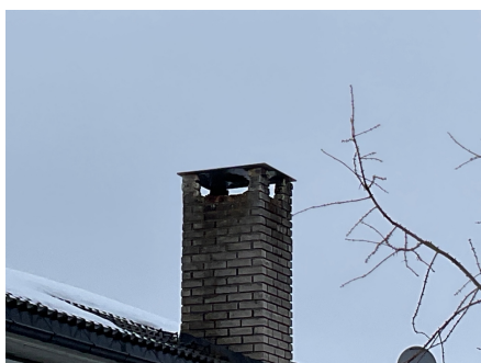
Pipe over tak med ødelagte steiner.
