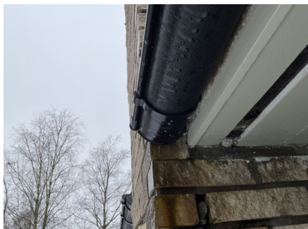
Takrenne med lekkasje
