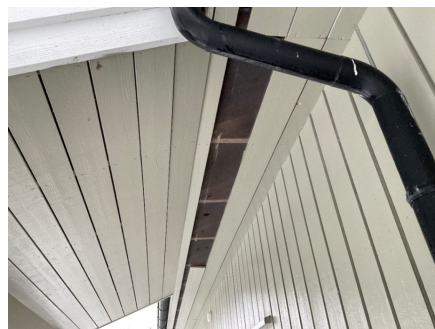
Manglende kledningsbord i takutstikk.
