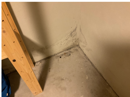
Fuktskjolder på synlig murvegg i bod under bakkenivå
