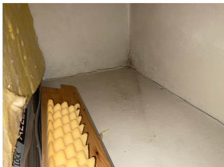
Sprekk i overgang mellom gulv og vegg.
