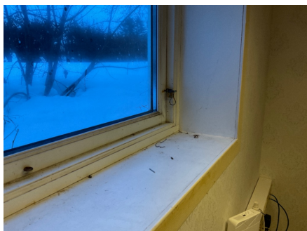
Vindu med fuktskjolder.
