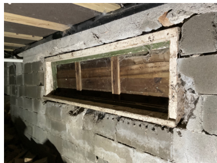
Sprekk i grunnmur.
