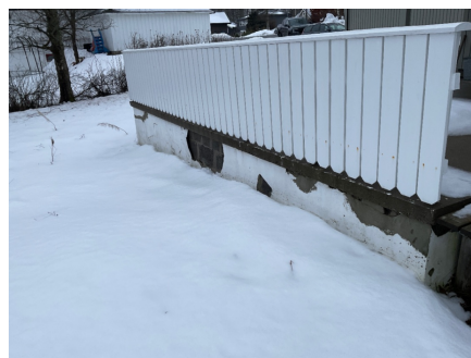
Terrasse med puss/malings avskalling
