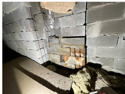
Fukt på grunnmur under pipe.
