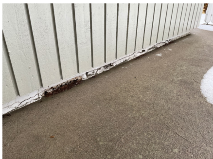
Pussavskalling og rust på jern i grunnmur.
