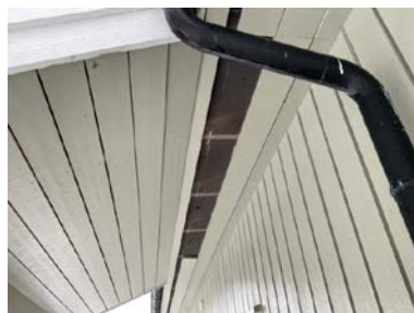
Manglende kledningsbord i takutstikk.
