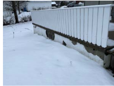
Terrasse med puss/malings avskalling
