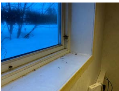
Vindu med fuktskjolder.
