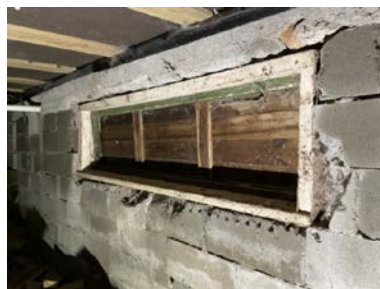
Sprekk i grunnmur.
