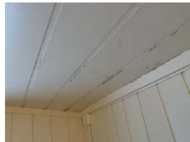
Svertesop på overflater i tak.
