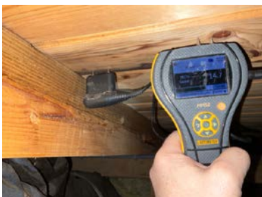
Fuktmåling på fuktskjolder i undertak
