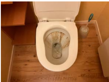
Toalett med lekkasje.
