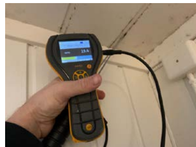
Fuktmåling på plater som har svertesopp.
