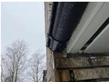
Takrenne med lekkasje
