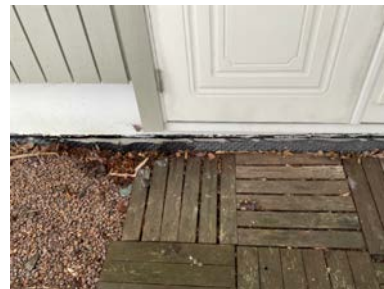
Skader på utvendig fuktsikring av grunnmur.
