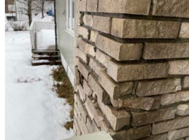
Ødelagte steiner på pipen
