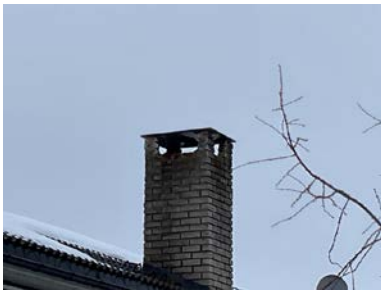
Pipe over tak med ødelagte steiner.
