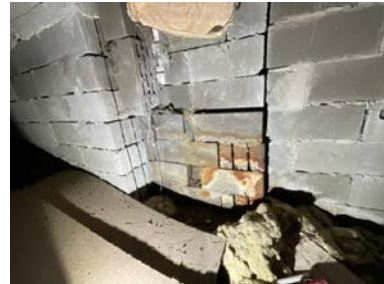
Fukt på grunnmur under pipe.
