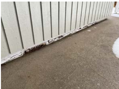
Pussavskalling og rust på jern i grunnmur.
