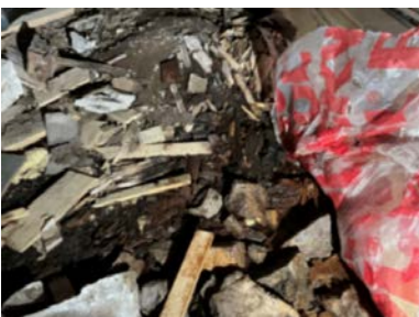
Tilsig av fukt i krypkjeller
