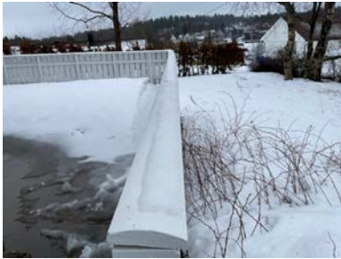
Rekkverk med skjevheter.
