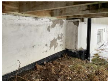
Sprekker og riss i grunnmur.
