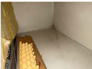
Sprekk i overgang mellom gulv og vegg.
