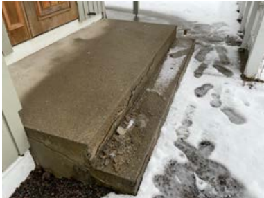
Pussavskalling på trapp.
