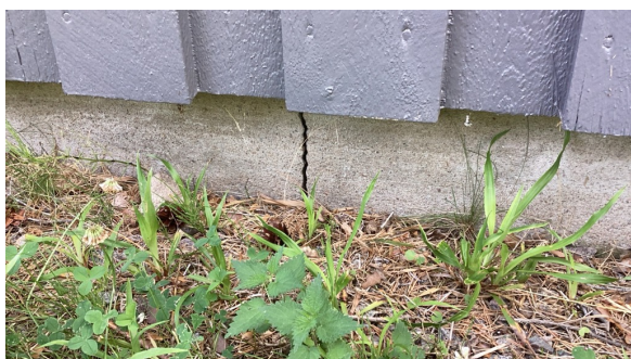
Eksempel på sprekk i grunnmur.
