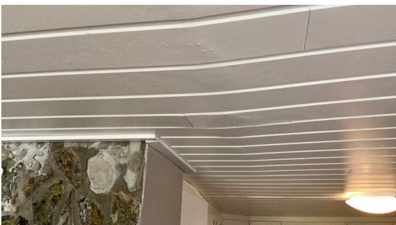
Fuktskader på himling i overgang stue/kjøkken etter lekkasje.
