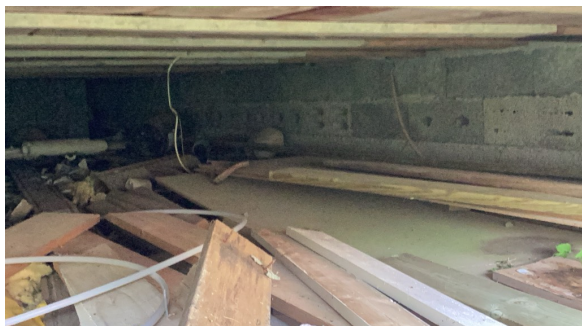
Det kommer noen kabler ned under hytta.
