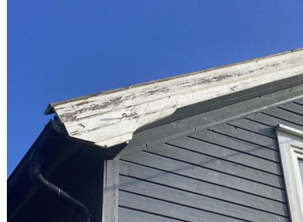
Eksempel på slitasje på vindski.
