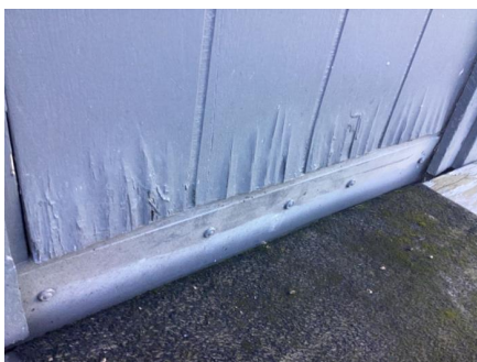
Fuktskade på sekundærdør.
