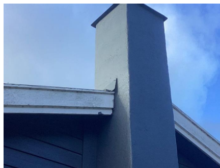
Risiko for utette overganger mellom beslag og pipe.
