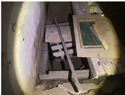
Grube i gulv i ett rom.
