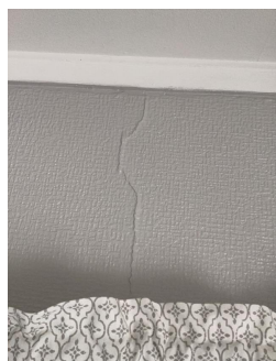
Eksempel på tapet som sprekker opp.
