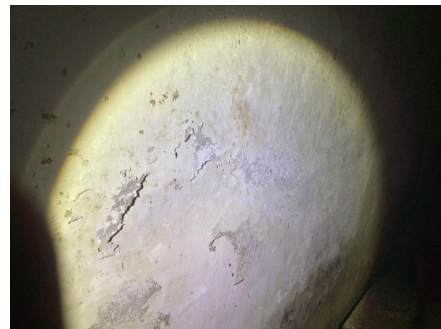
Eksempel på avskaling på vegg.
