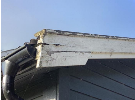
Eksempel på råte på vindski.
