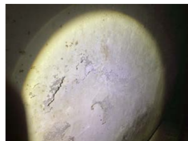
Eksempel på avskaling på vegg.
