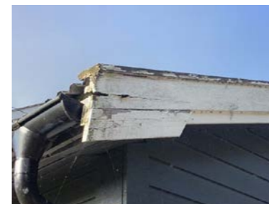
Eksempel på råte på vindski.
