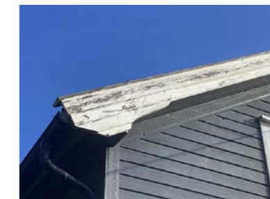
Eksempel på slitasje på vindski.
