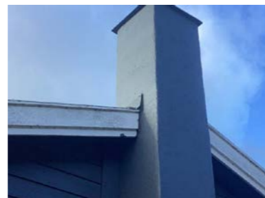
Risiko for utette overganger mellom beslag og pipe.
