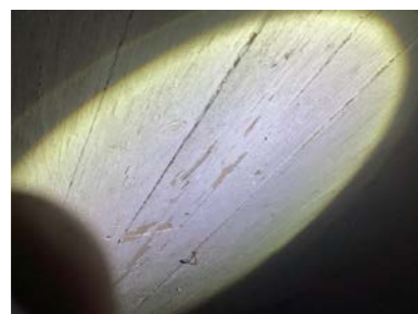
Stedvis avskaling av maling i himling.
