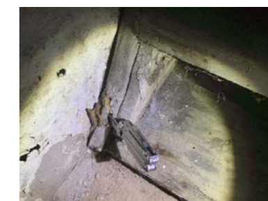
Råte på trapp til kjeller.
