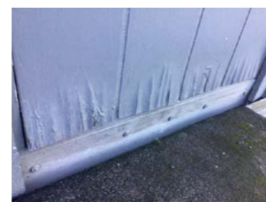
Fuktskade på sekundærdør.
