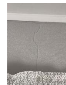
Eksempel på tapet som sprekker opp.
