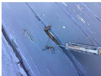
Råte i takkonstruksjon.
