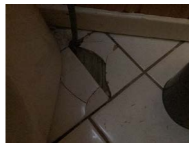
Eksempel på skade på fliser på gulv.
