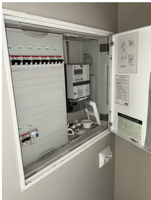
Sikringsskap er plassert i entre.
