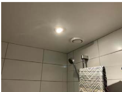
Spot er plassert i tak over dusj-sone.
