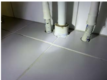
Ingen mansjett på rør-føringer.
