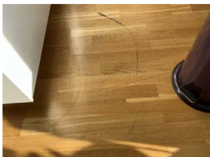
Større riper i parkett ved kjøkken.
