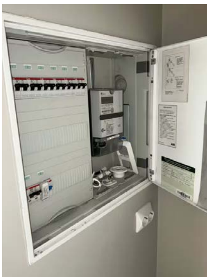
Sikringsskap er plassert i entre.
