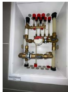
Samleskap med rørkurser og stoppekraner
