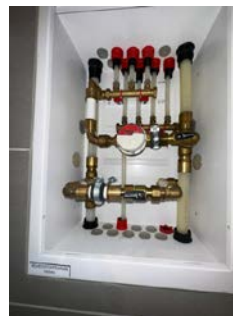
Samleskap med rørkurser og stoppekraner
