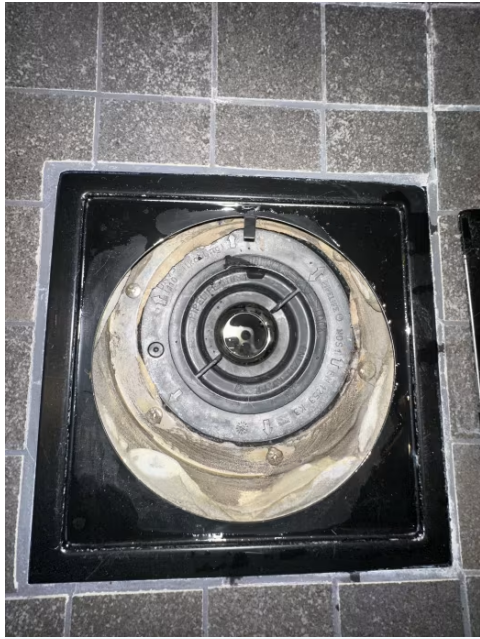
Viser sluk i dusjsonen.
