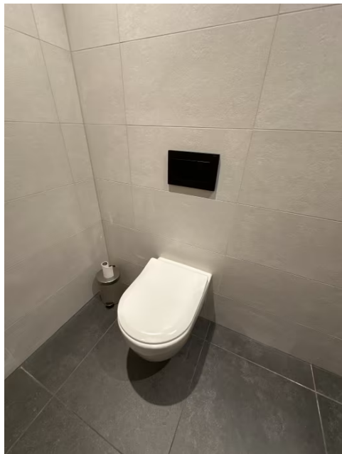
Vegghengt toalett med innebygget sisterner.
