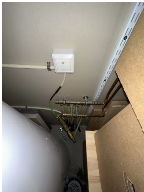
Viser vanninntak, hovedstoppekran og åpen fordeler.
