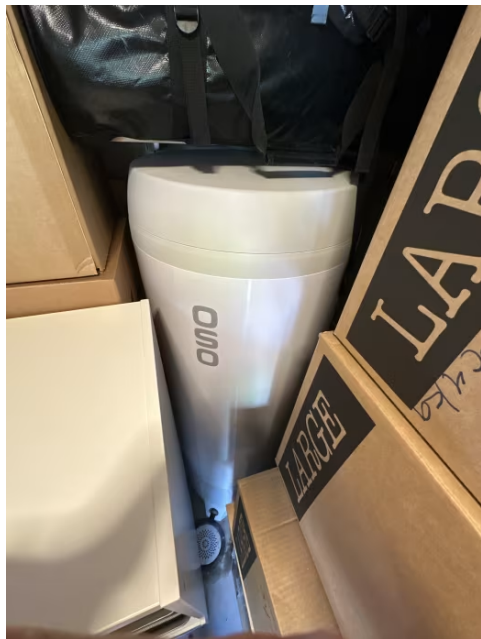
Viser bereder plassert i bod.
