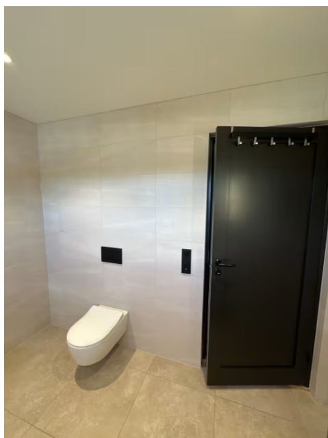
Viser vegghengt toalett med innebygget systerne.
