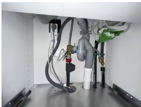
Viser vann og avløpsinnstallasjoner under kum.
