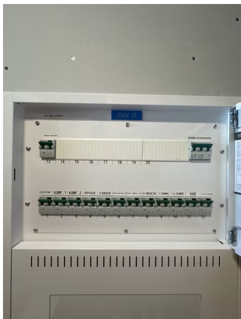
Viser sikringsskap montert i bod.
