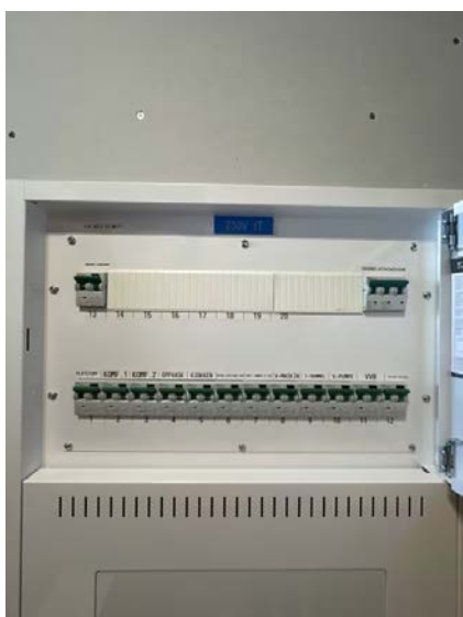
Viser sikringsskap montert i bod.
