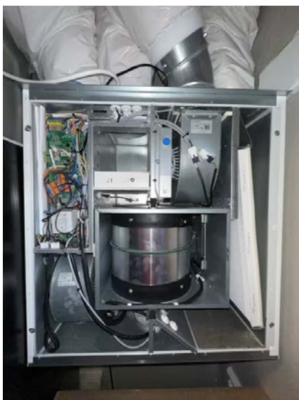
Viser ventilasjonsaggregat plassert i bod med utvendig adkomst.
