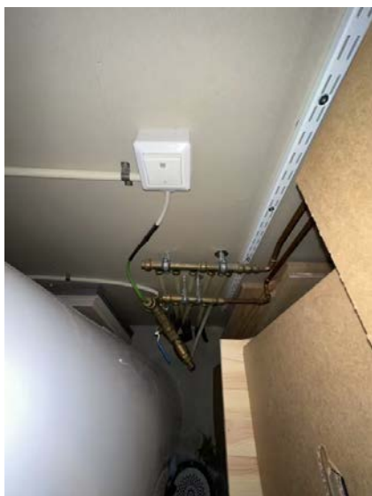
Viser vanninntak, hovedstoppekran og åpen fordeler.
