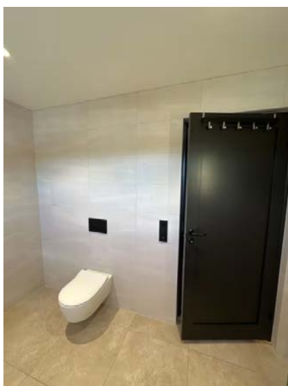
Viser vegghengt toalett med innebygget sisterner.
