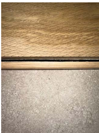
Viser oppbrett på membran ved terskel.
