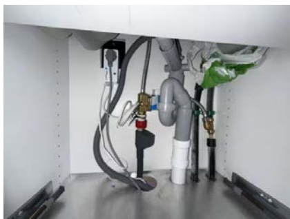
Viser vann og avløpsinnstallasjoner under kum.
