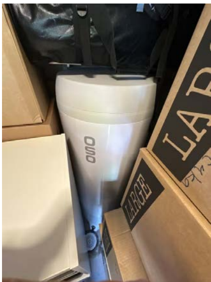
Viser bereder plassert i bod.
