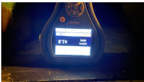
Fukt og råte i ganggulv
