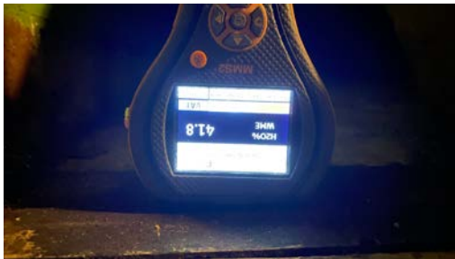
Fukt og råte i ganggulv
