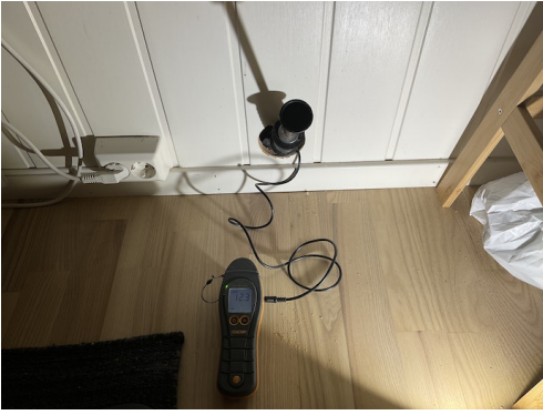
Hulltaking tatt på sørveggen, inne på kjøkken - Hybel 1.
