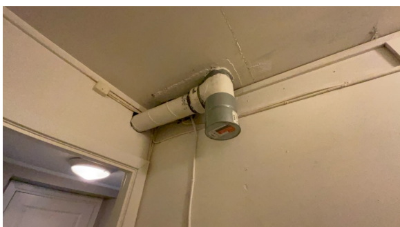
Grunnvent kjøkken er koplet ut.
