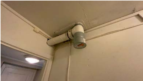
Grunnvent kjøkken er koplet ut.
