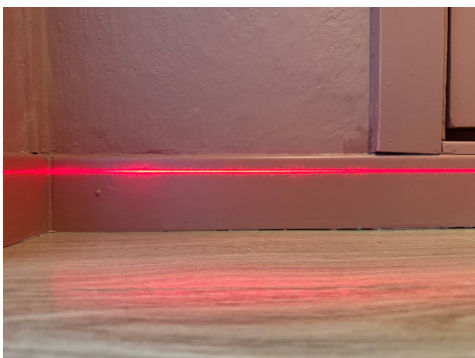
Bilder viser skjevheter i gulv i entre/gang.
