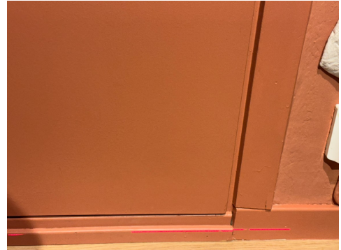
Bilder viser skjevheter i gulv i entre/gang.
