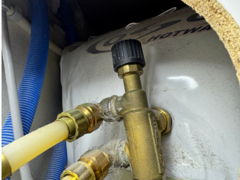
Varmtvannstank i kjøkkenskap.
