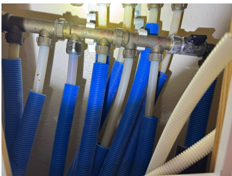
Rørsentral i himling på bad.
