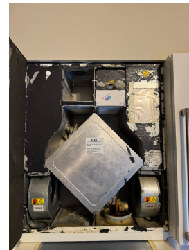
Innmat på luftbehandlingsaggregat.
