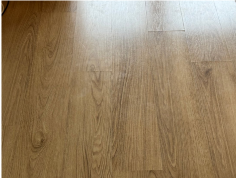
Fuktutsvelling i laminatskjøter i stue.
