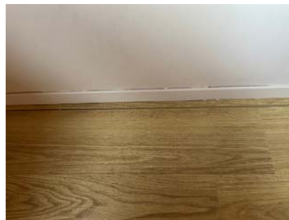
Glip i laminatgulv inntil vegg på soverom 2.
