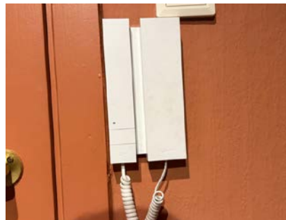
Dørtelefon i entre/gang.
