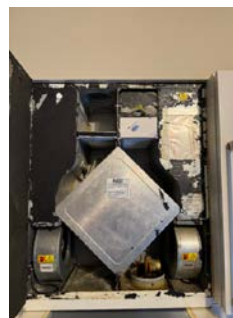
Innmat på luftbehandlingsaggregat.
