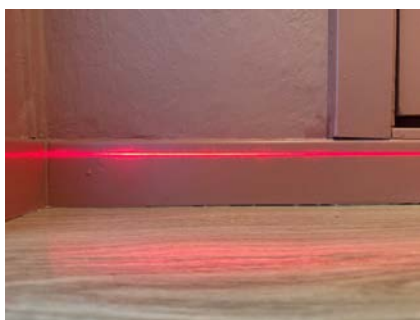
Bilder viser skjevheter i gulv i entre/gang.
