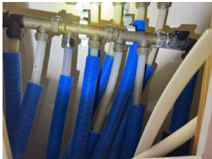
Rørsentral i himling på bad.
