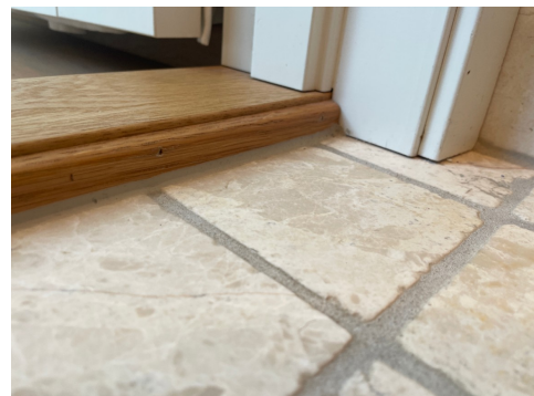
Riss i fugemasse.
