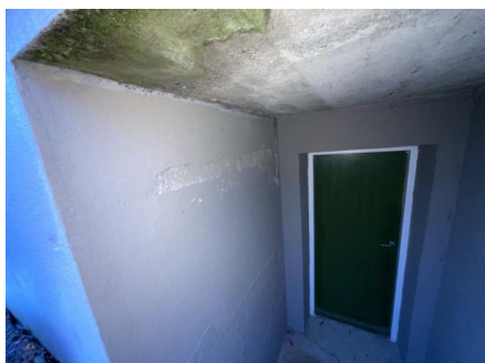
Saltutslag er synlig under repo på trapp som følge av manglende membran/tekking under terrassebord
