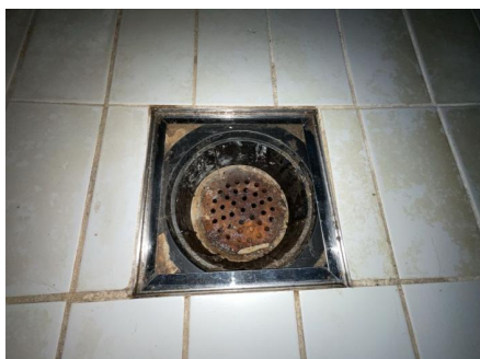
Soiisluk fra byggeår uten synlig membran på gulv
