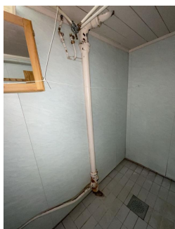
Åpen avløpsrør inne på dusjrom i kjeller
