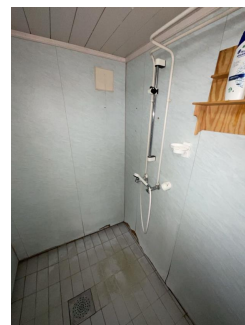
Oversikt mot dusj og skadde plater
