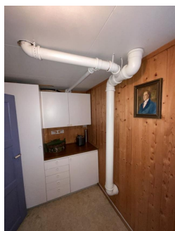
Avløpsrør i plast fra bad i 1. etasje og ut av bolig.
