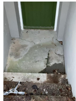
Sprekk i betongdekke foran dør i kjeller.
