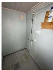
Oversikt mot dusj og skadde plater
