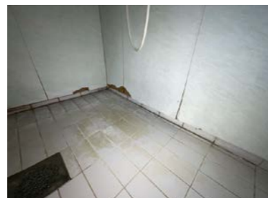
Synlige skader på våtromsplater
