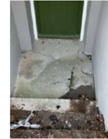
Sprekk i betongdekke foran dør i kjeller.
