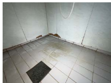
Synlige skader på plater i dusj
