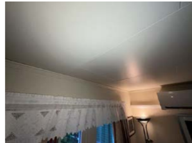
Eldre fuktskade er synlig på himlingsplater over balkongdør i stue. Skadeårsak er utbedret ved renovering av yttervegg ifølge kontaktperson.
