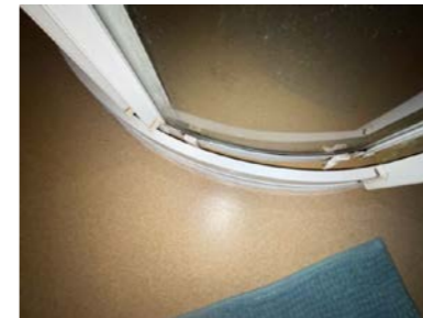
Ett hjul på dusjdør er skadet/borte
