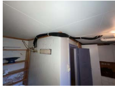
Åpne rør og fordelerkolber montert på vegg
