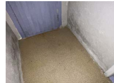
Synlig saltutslag/misfarging på vegg i kjeller ved utgang
