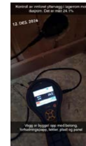
Kontroll av innforet yttervegg i lagerrom mot dusjrom. Det er målt 24,1%. Vegg er bygget opp med betong, forhudningspapp, leter, plast og panel.
