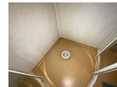
I bunn av plater i dusj er det fuget
