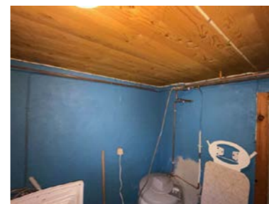
Vannrør inne i vaskekjeller
