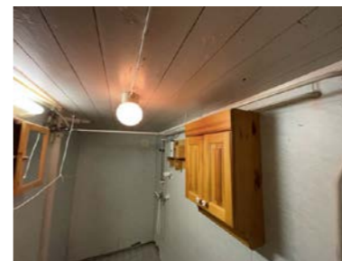
Åpne rør inne på dusjrom
