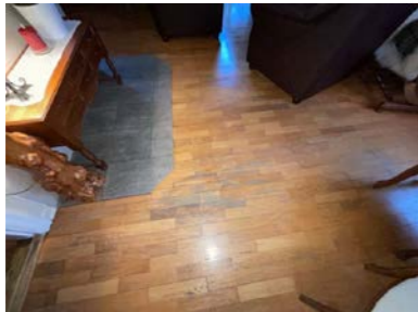
Slitasje på parkett stue
