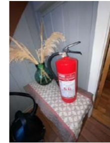
Brannslukker fra 2015 i gang ved sikringskapet.
