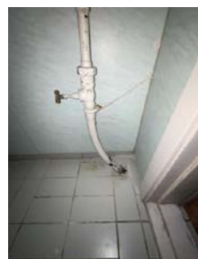
Plastrør frem til hovedstoppekrane
