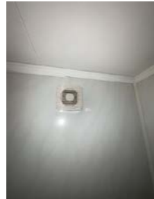
Mekanisk avtrekksvifte på vegg
