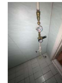
Hovedstoppekrane med reduksjonsventil og vannmåler
