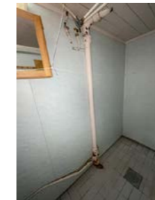
Åpen avløpsrør inne på dusjrom i kjeller
